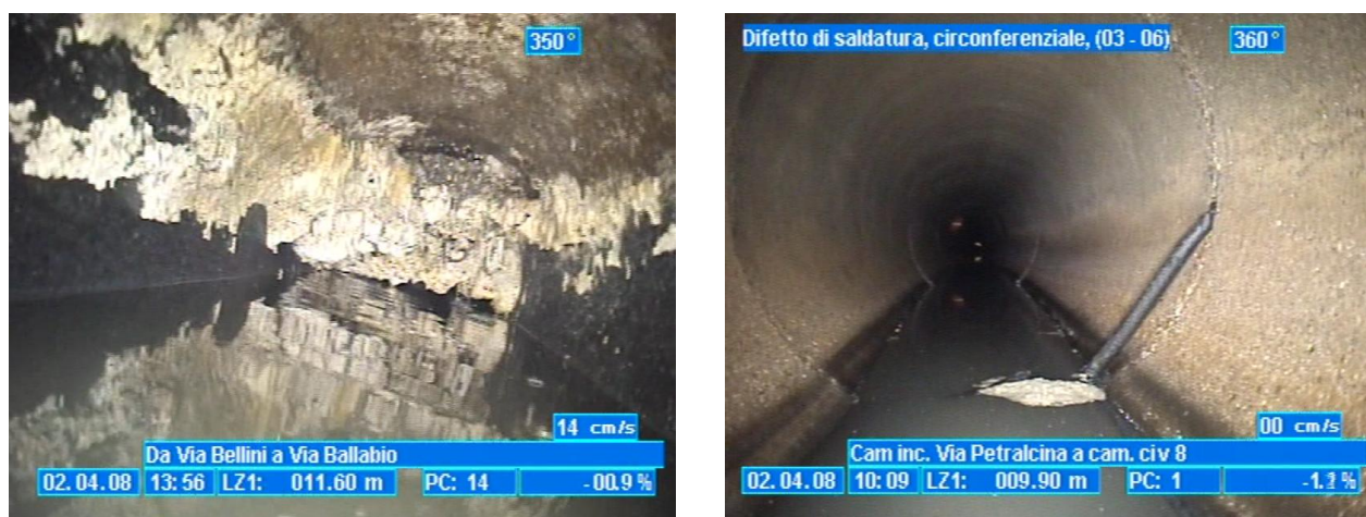
Fig. 488 – Estratti fotografici di alcuni tratti fognari caratterizzati da problemi di scarico ed intasamento.
