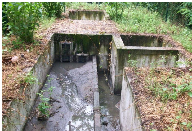
Fig. 475 – Scaricatore di piena a cielo aperto in frazione Carpenzago con regolatori di portata a stramazzo.
