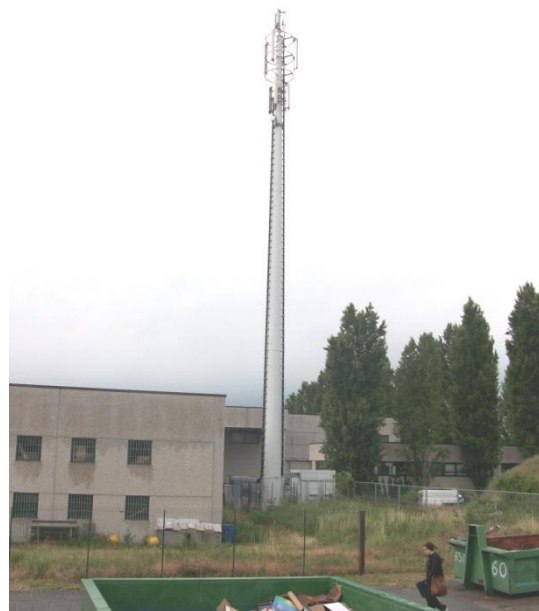
Fig. 484 – Stazione radio-base di via Ugo Foscolo.
