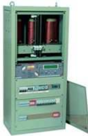
Fig. 8 : Esempio di quadro contenete un trasformatore serie di tipo BOOSTER.
