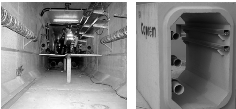
Tunnel tecnologici per la distribuzione primaria degli impianti
