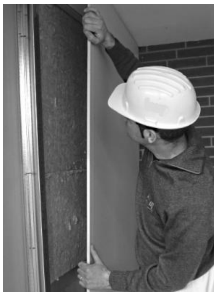
Pannelli in lana di roccia posti all'interno di una parete stratificata a secco
