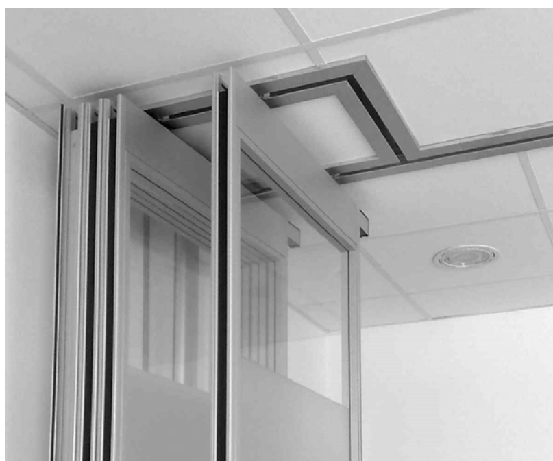
Particolare delle guide montate a controsoffitto delle pareti manovrabili leggere
