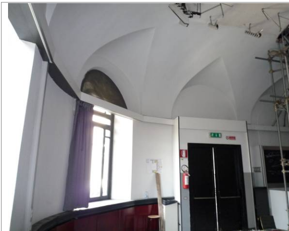
Figura 69 – Edificio 3_a1, Aula S 1.8. Porzione di volta in cui i lati nord ed est si congiungono mediante una curva formando nella geometria tridimensionale uno spicchio di sfera. Le lunette de lati nord ed est corrispondono alle finestrate.
