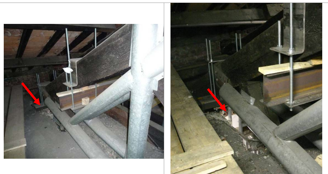
Figura 38 – Capriata C4, individuazione del danneggiamento della volta nel piano sottotetto.
