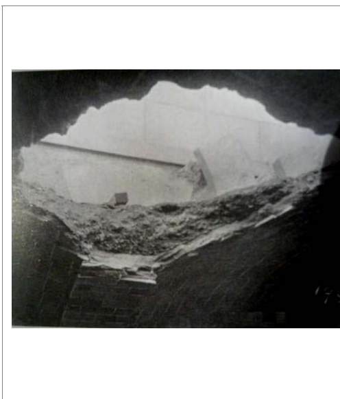
Figura 133 – Danno localizzato su una volta della Biblioteca di Boston, a seguito della caduta di un masso (da OCHSENDORF, Guastavino Vaulting: The Art of Structural Tile , USA, 2010).
