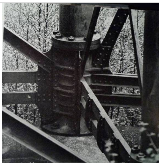
Figura 82 - Viadotto sul Bouble, G. Eiffel, nodo di giunzione delle colonne verticali che formano il pilone, 1861 (da JODICE, ROISECCO, VANNELLI, L'architettura del ferro, la Francia (1715-1914) , Roma, 1973, p. 309).
