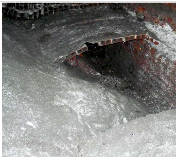
Figura 72 - Estradosso della volta. Data la mancanza di una porzione della controvoletta è possibile osservare l'estradosso della lunetta.
