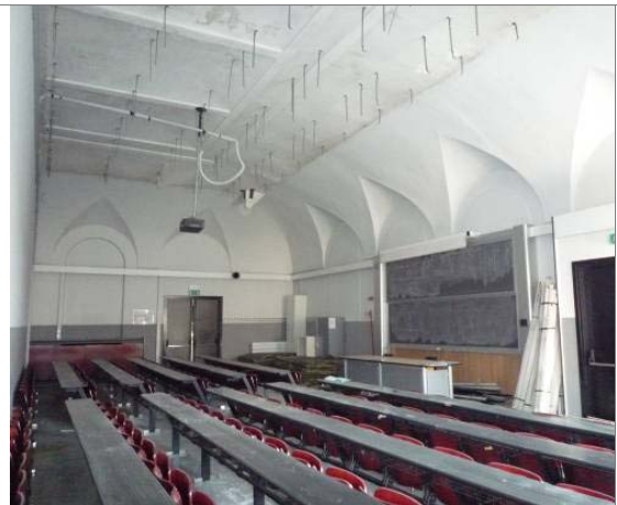
Figura 70 – Edificio 3_a1, Aula S 1.1. Porzione di volta in cui i lati sud ed ovest si congiungono mediante un angolo retto formando nella geometria tridimensionale la tipica forma delle volte a padiglione. Le lunette del lato sud ed ovest corrispondono ad elementi decorativi.
