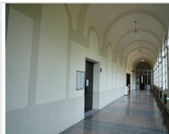
Figura 62 – Edificio 3_a2, volta in corrispondenza del corridoio annesso all'aula principale.
