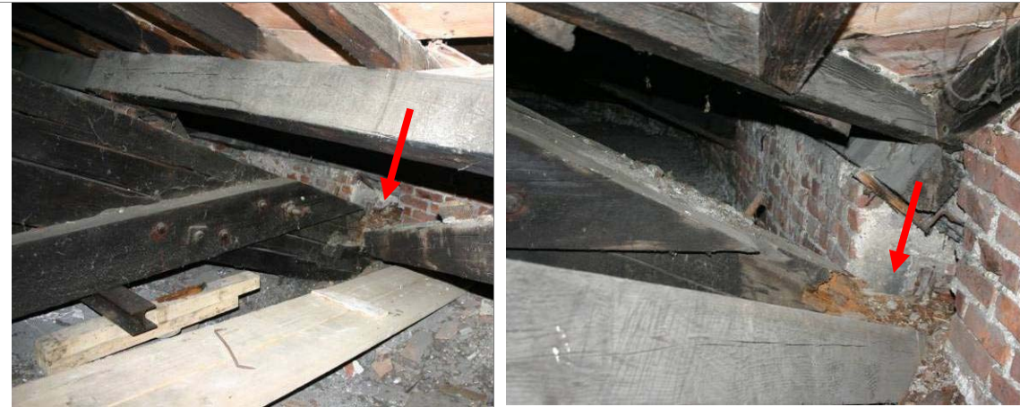
Figura 36 – Capriata C3, dettaglio del puntone in corrispondenza della zona di inserimento nel muro verso est. La freccia rossa indica l'elemento soggetto a marcescenza.
