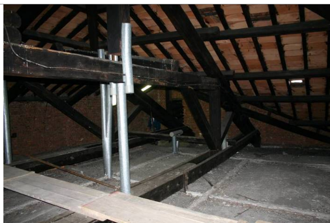
Figura 46 – Capriate C1 e C2 – Corrispondenza tra la catena della capriata lignea e l'estradosso della volta.
