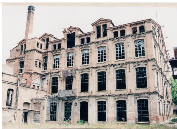
Figura 193 - Ca l'Aranyò , Poblenou, Barcellona. Stato di fatto prima dell'intervento di conservazione (Immagine tratta dalla presentazione di A. Vilanova e E. Simó Il recupero del complesso industriale di Cà l'Aranyò per la Università Pompeu Fabra ).
