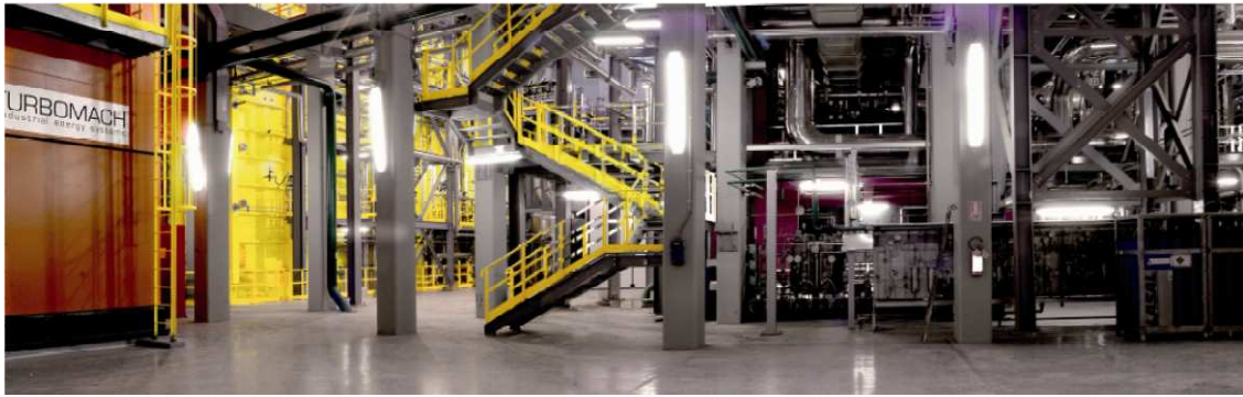
Figura 4.70: Centrale di cogenerazione di Imola (interno)
