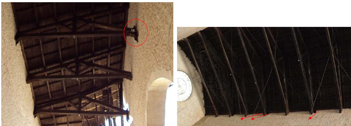
Figura 3-13 Danni relativi alla copertura della chiesa di Santa Maria di Collemaggio
