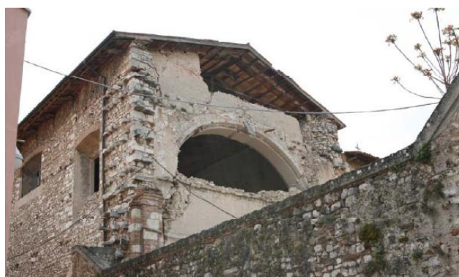
Figura 3-12 Danni relativi alla copertura della chiesa S.S. Nicandro e Marciano
