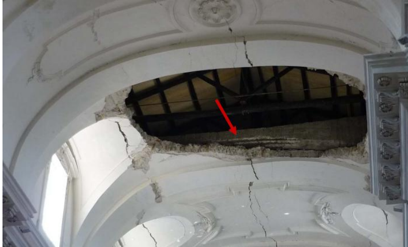
Figura 5-1 Danni nella chiesa di Santa Maria dei Raccomandati
