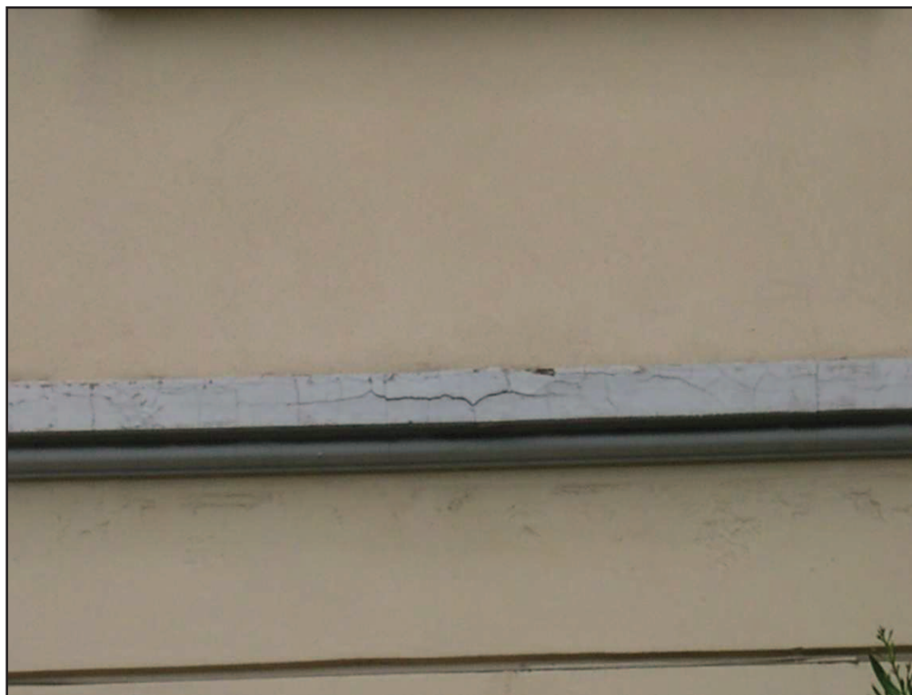
Figura 46 Lesioni su cornicione piano primo
