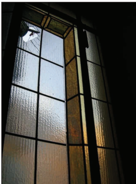
Figura 47 Condizioni di alcuni elementi finestrati dei vani scale
