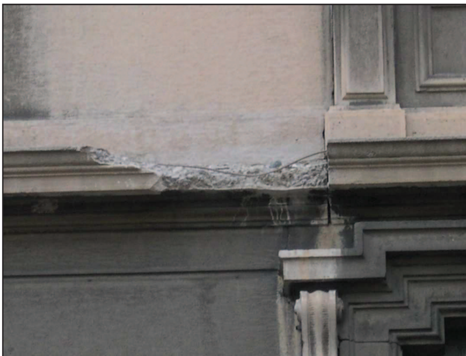
Figura 40 Assenza di parte del davanzale di un cornicione
