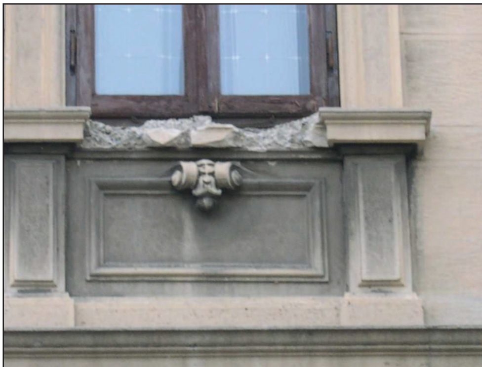
Figura 39 Assenza di parte del davanzale di una finestra
