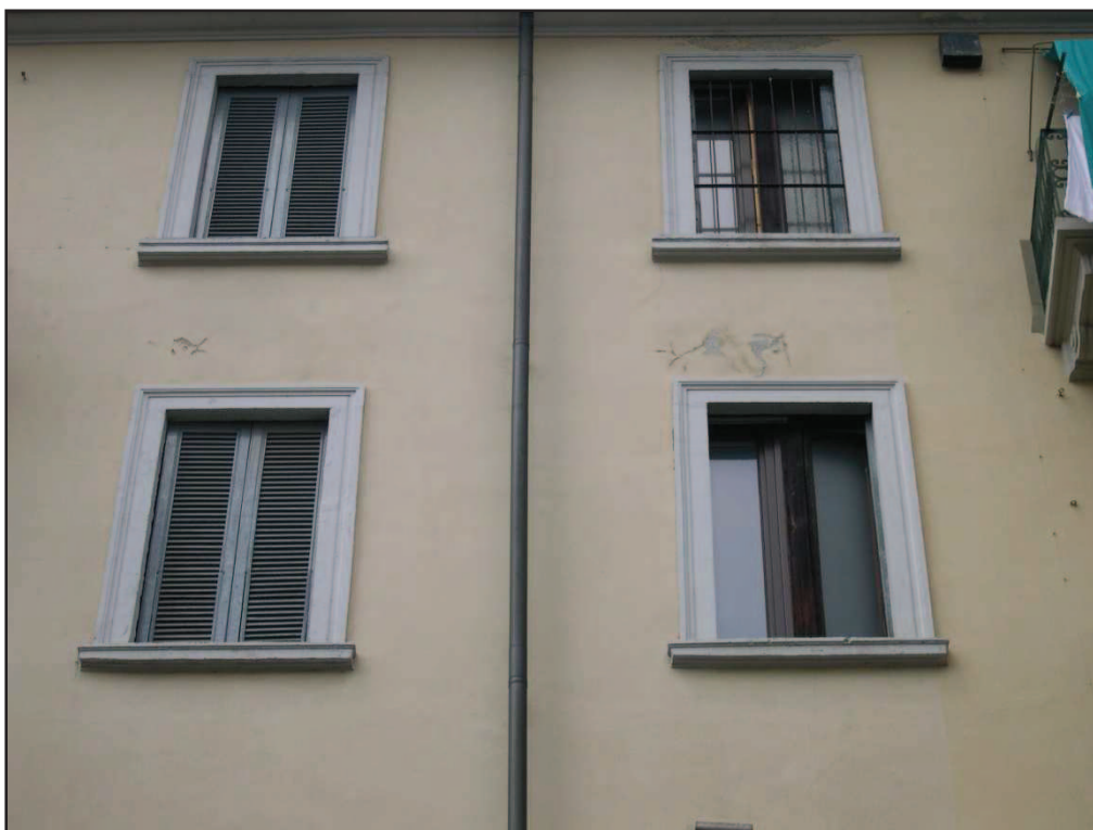
Figura 43 Presenza di distacchi ed assenza di strato di pitturazione della facciata sul cortile interno
