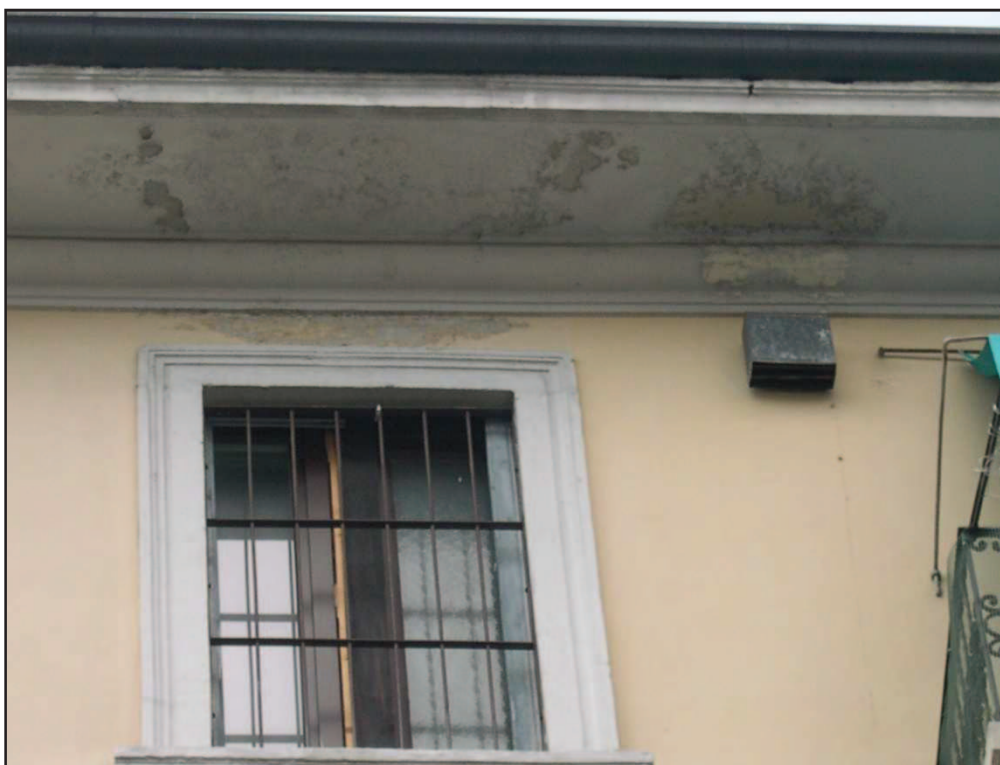
Figura 45 Distacchi/assenza pitturazione sottogronda
