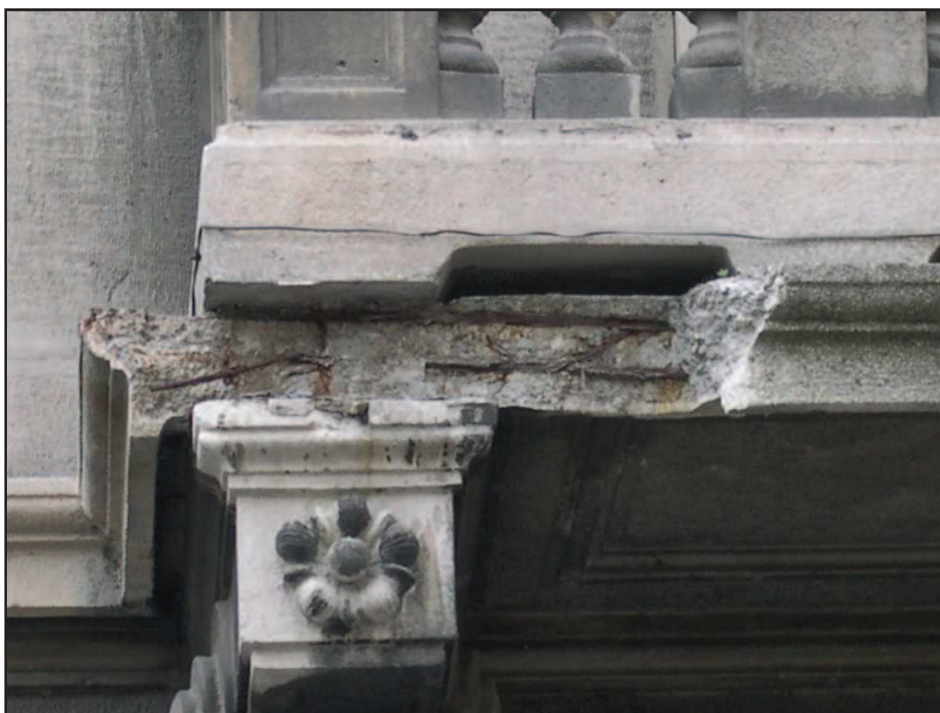
Figura 41 Assenza di parte della soletta di un balcone
