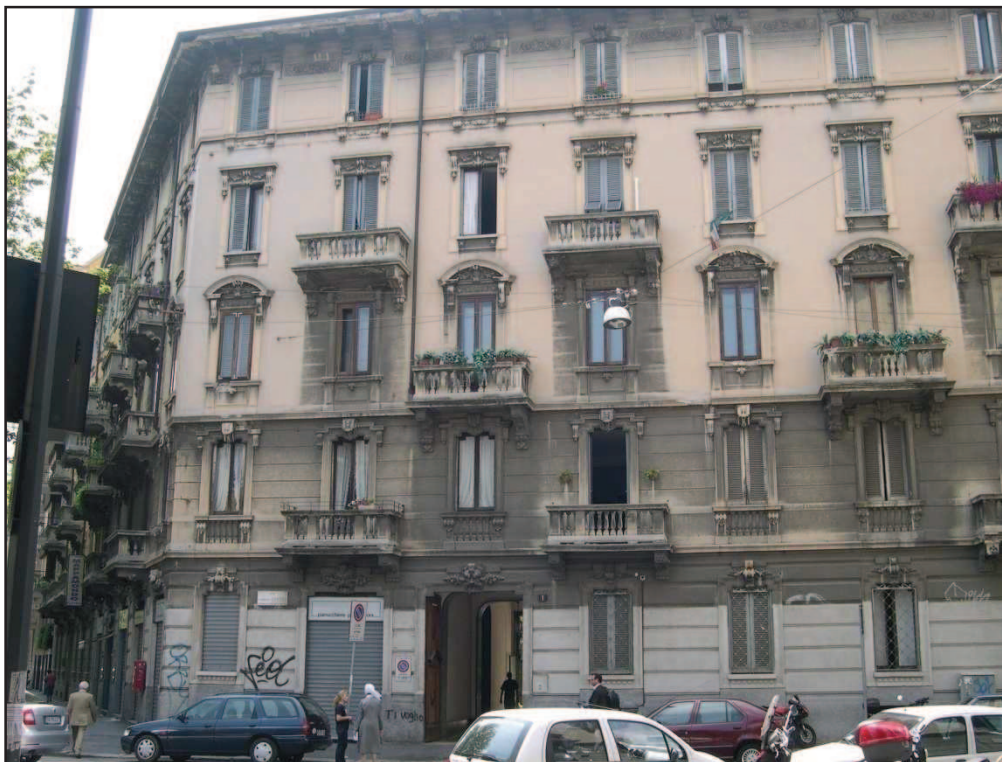
Figura 42 Dilavamento facciata su via Gentili
