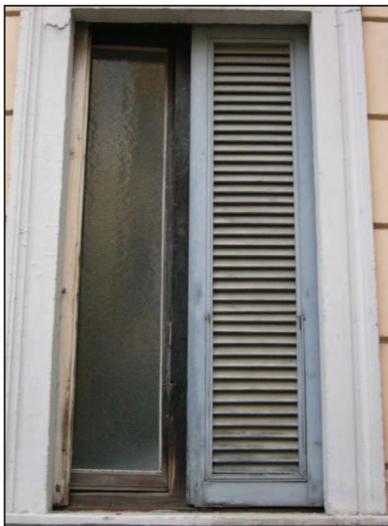
Figura 48 Condizioni di molti serramenti ed oscuranti
