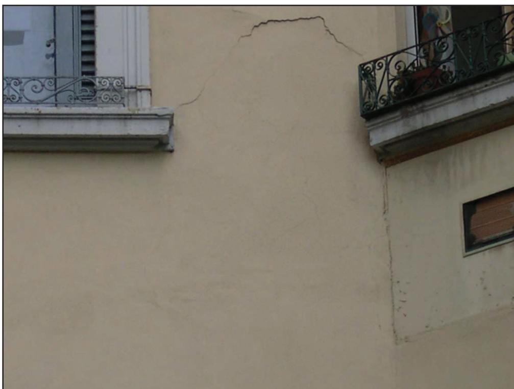
Figura 44 Presenza di lesioni sulla facciata del cortile interno
