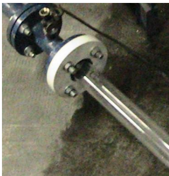
Figura 4.35 Flangia fissata con bulloni e dadi al resto dell'impianto.
