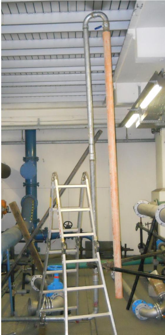
Figura 4.27 Tratto di tubazione che prosegue in verticale fino alla quota sommitale del soffitto, per poi dirigersi nuovamente verso il basso per lo scarico.
