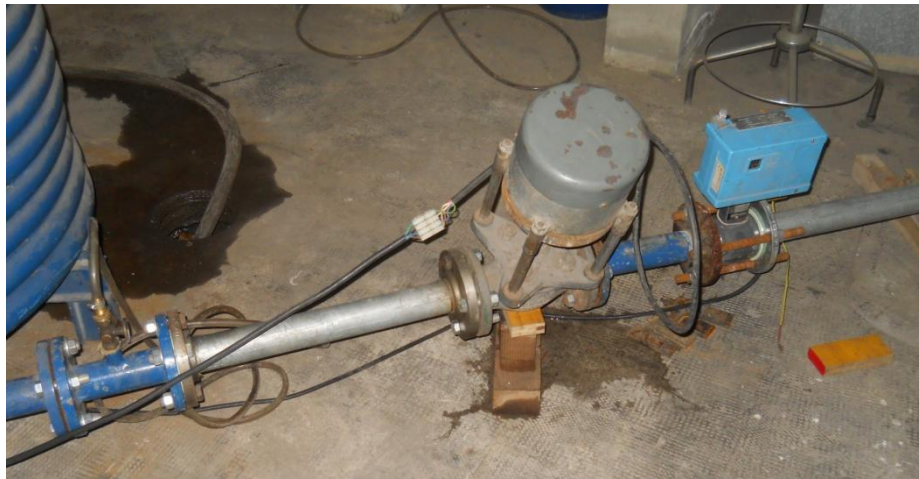
Figura 4.26 Ordine con cui sono posti gli strumenti: partendo da monte verso valle si trova il misuratore di portata, l'elettrovalvola, il manicotto e le due bobine.
