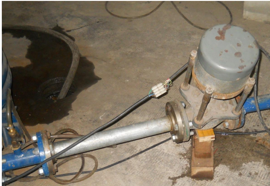
Figura 4.34 Tubo in ferro (a valle dell'elettrovalvola) sostituito.
