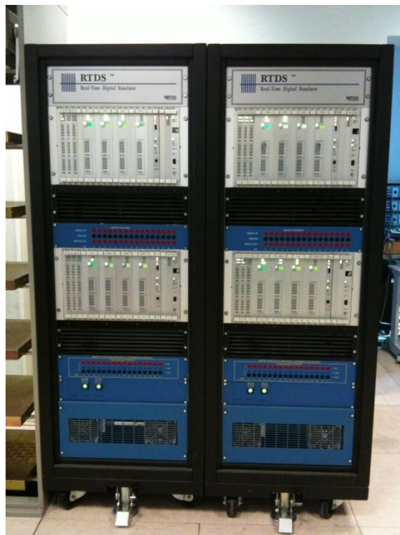
Figura 5.2.1 RTDS presso Centro Prove ENEL
