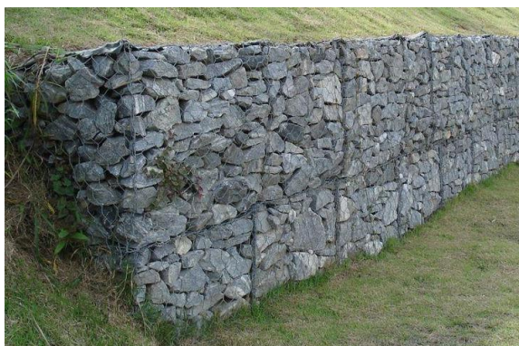
Figura 227 - Muro a gravità in gabion wall per il contenimento di un pendio
