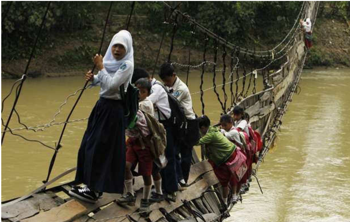
[Fig.6.2.1] Abitanti di Sanghiang Tanjung (Indonesia) attraversano un ponte danneggiato dalle piogge
