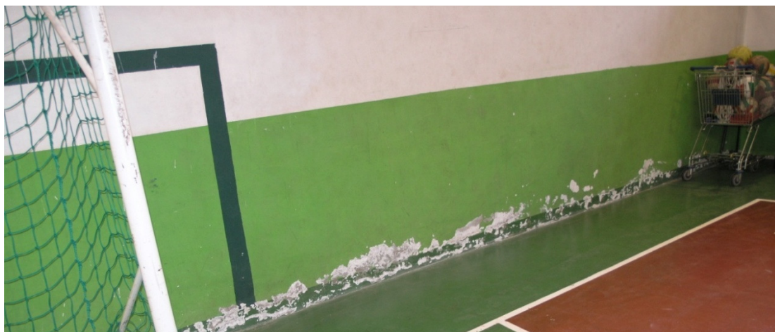
Figura 3.3-9 Degrado interno, prospetto Est. Degrado presente: distacco dell'intonaco.
