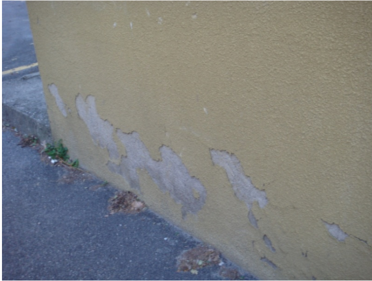
Figura 3.3-5 Degrado esterno riferito al prospetto Sud. Degrado presente: distacco dell'intonaco.
