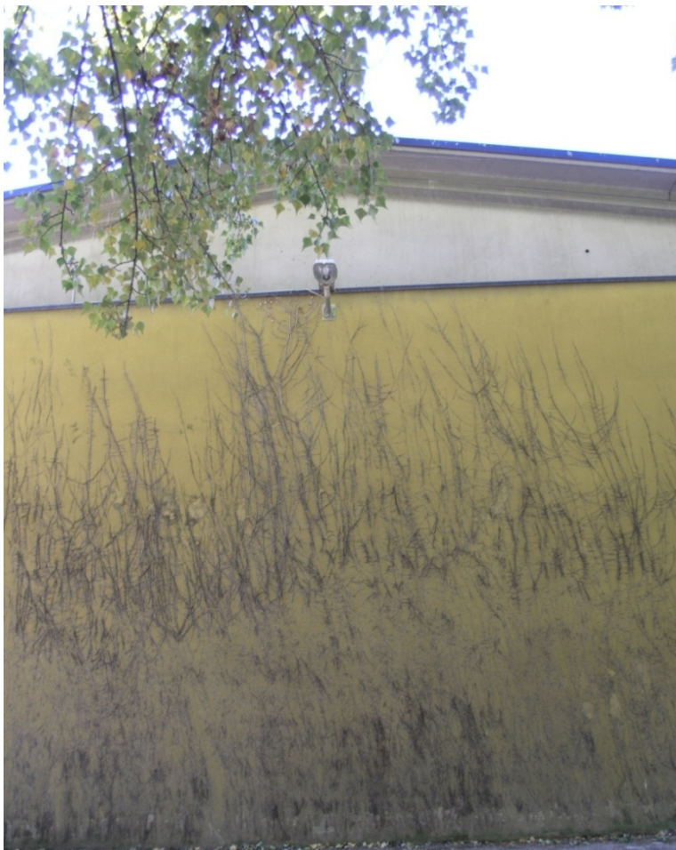
Figura 3.3-6 Degrado esterno riferito al prospetto Nord. Degrado presente: vegetazione.
