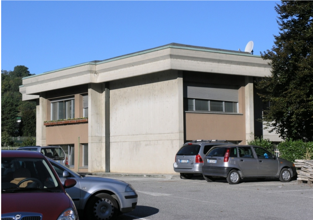
Figura 3.2-7 Vista prospettica del lato Sud - Ovest della Palazzina dell'ex Custode. Degrado presente: patina biologica.
