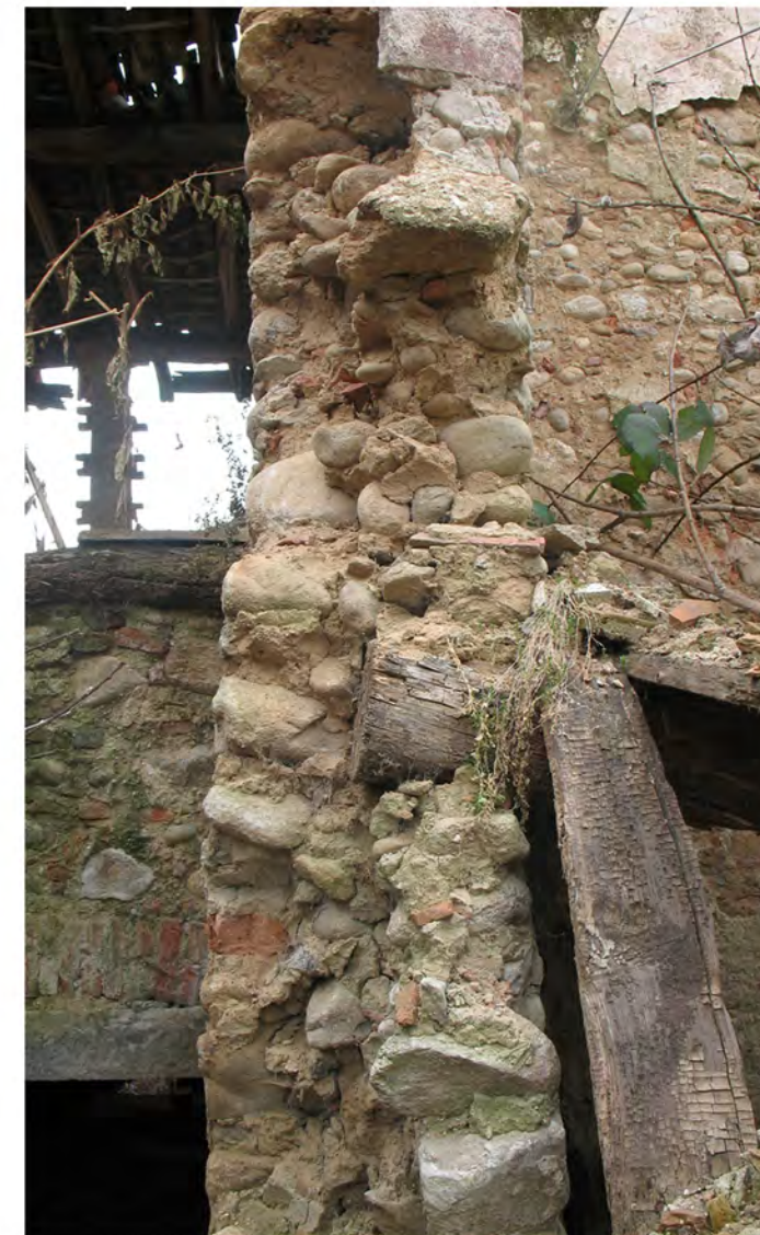
► Particolare di parete portante del primo corpo edilizio (Stalla), soggetta a cedimento strutturale
