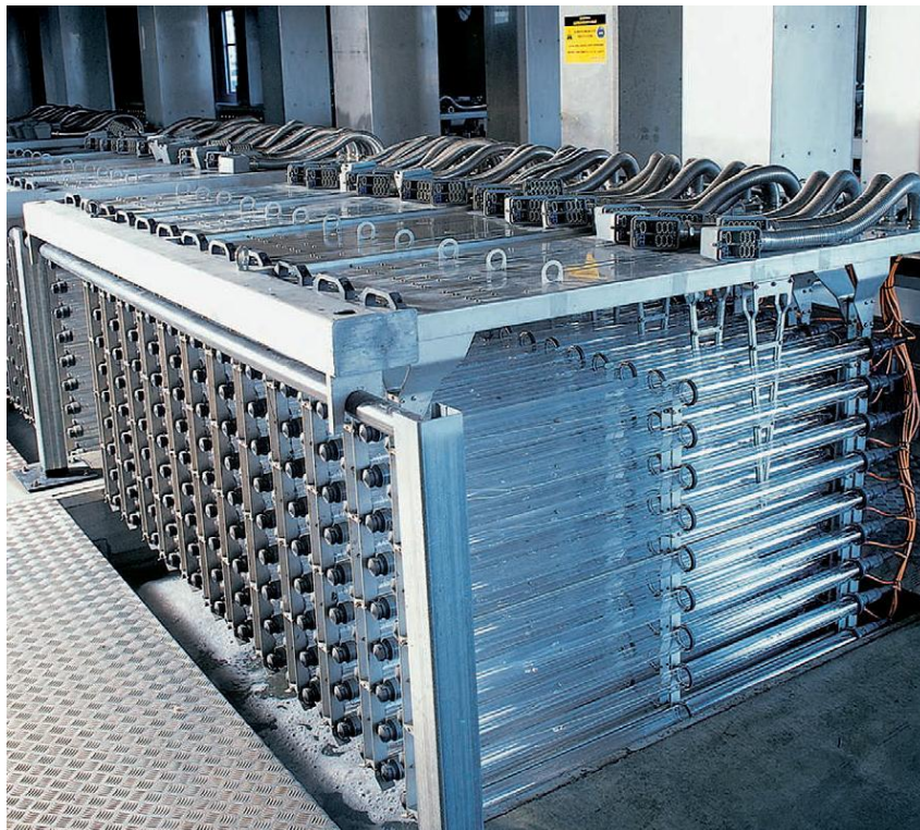
Figura 3.5: i grandi banchi di lampade dei canali dell'impianto di Manukau in Nuova Zelanda
