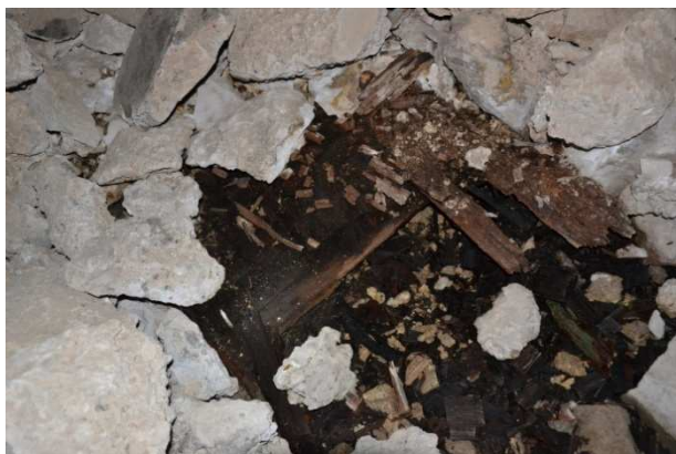
Figura 20-21-22 Particolare forte cimo: riserve laterali per le munizioni con particolari del pavimento ligneo e canali per la condensa.
