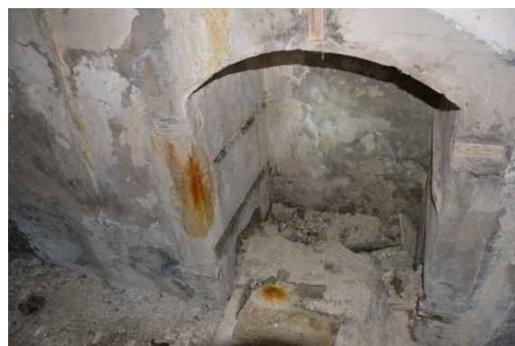
Figura 88 – nicchie per l'alloggiamento delle pompe di pescaggio dell'acqua dalle cisterne.
