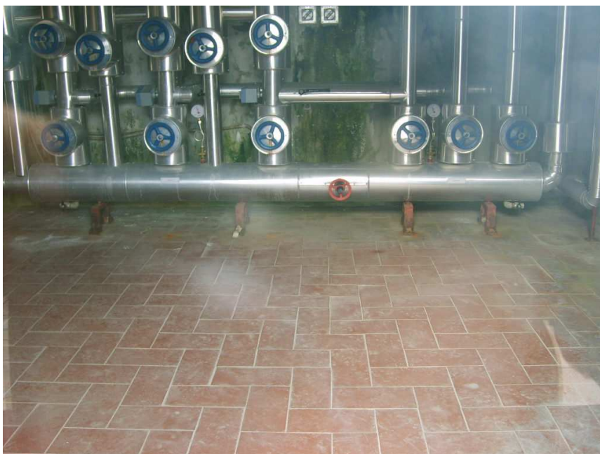
Figura 197-centrale termica del corpo nord del primo cortile
