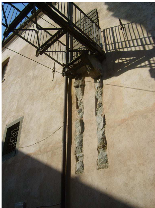
Figura 196-ponticello di collegamento fra il maschio e la manica nord del dado-situazione 2011 (vista dal cortile del maschio)
