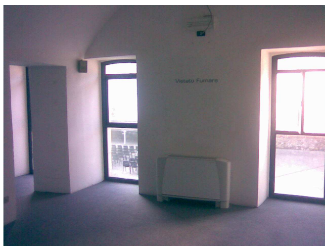
Figura 186-impianto di riscaldamento (particolare elementi scaldanti)
