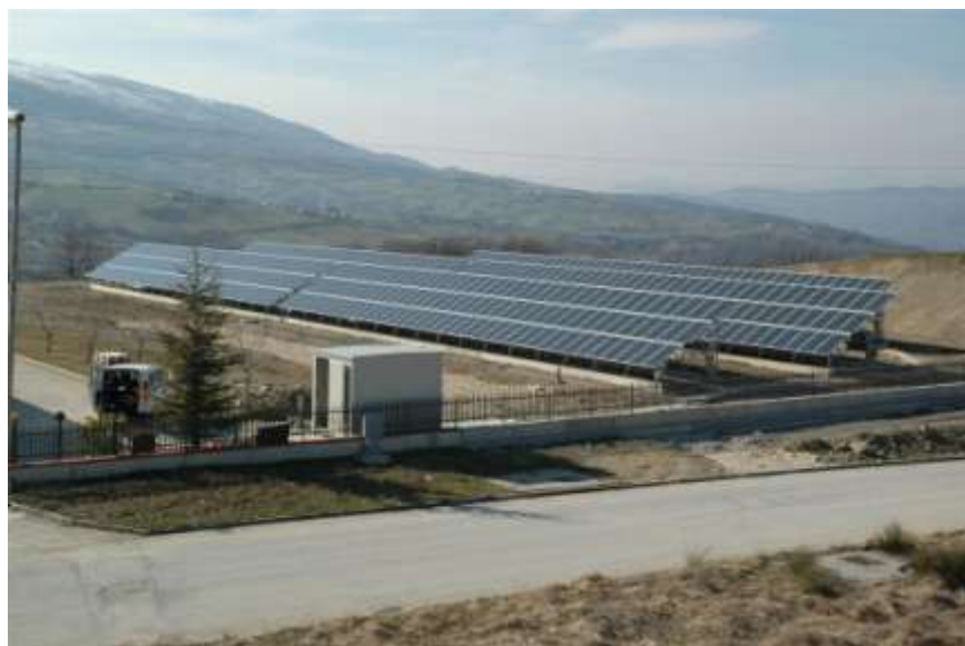
Figura 7. Veduta complessiva impianto
