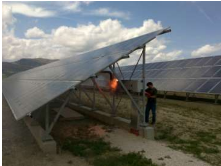
Figura 18. Tentativo di spegnimento con cassetta ancora sotto tensione
