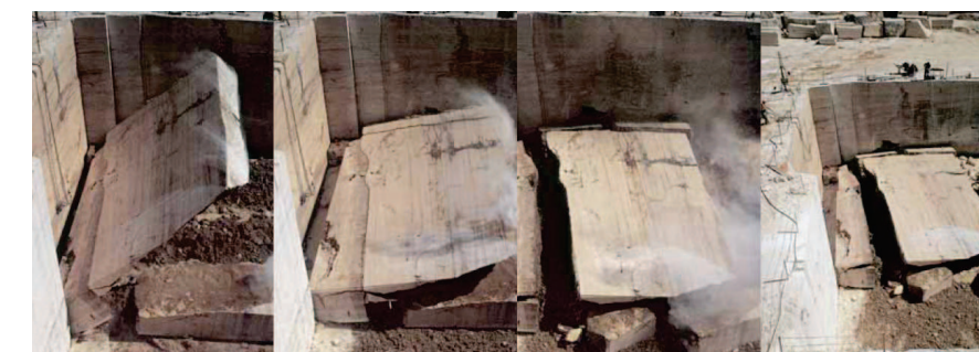
Fig. 1.12_Distacco e ribaltamento di un blocco eseguito con cuscini a acqua e martinetti
