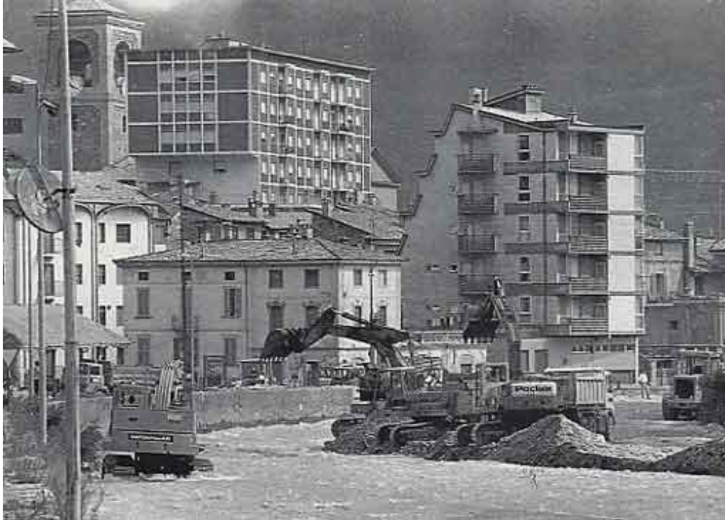
Fig. 4.10 – Livello raggiunto dalle acque del Mallero in occasione dell'alluvione dell'87
