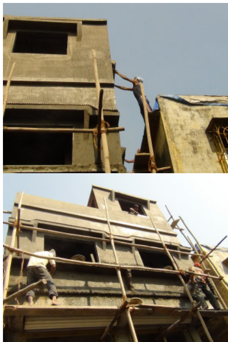
figura 38. Facciata in costruzione del nuovo edificio di Pankaj Gupta. Foto: Francesco Galli
