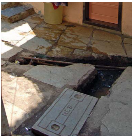
figura 214. Canale fognario interno a cielo aperto. Fonte: www.theperfectslum.blogspot.it
