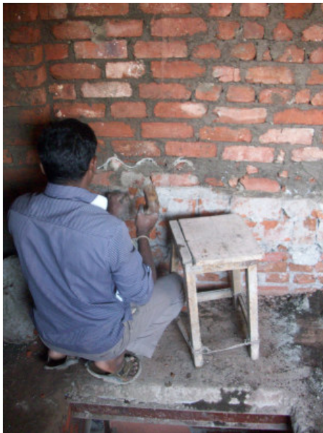
figura 170. Sovrapposizione gronda abitazione adiacente con il muro in costruzione. Fonte: Francesco Galli
