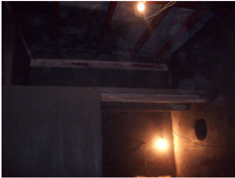
figura 164. (alto) Spazio destinato al serbatoio al piano terra. Fonte: Francesco Galli
