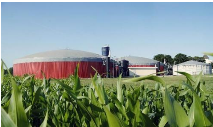
Figura 101_ Impianto biogas modulare - foto tratta dal sito agricolturaonweb.imaginenetwork.com
