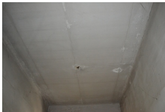
FIGURA 43 - RUGGINE IN AFFIORAMENTO
