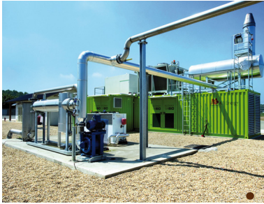
unità di cogenerazione
