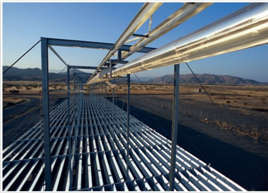
Figura 1.5. Collettori Fresnel dell'impianto di Almeria
