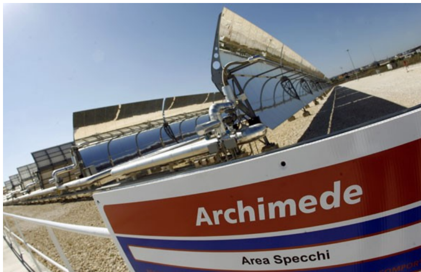
Figura 1.6. Centrale a collettori parabolici lineari di Priolo Gargallo (SR)
