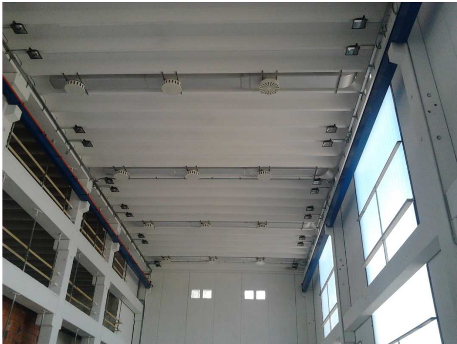
Figura 3.8: Installazione diffusori zona simulatori FFS.
