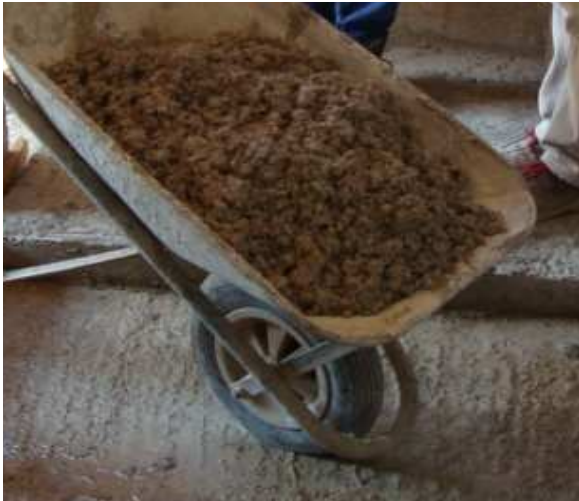
Fig. 3.91 Trasporto tramite carriola, ANAB, (2011), Presentazione Cantiere Scuola: isolanti naturali, S.Matteo della Decima
