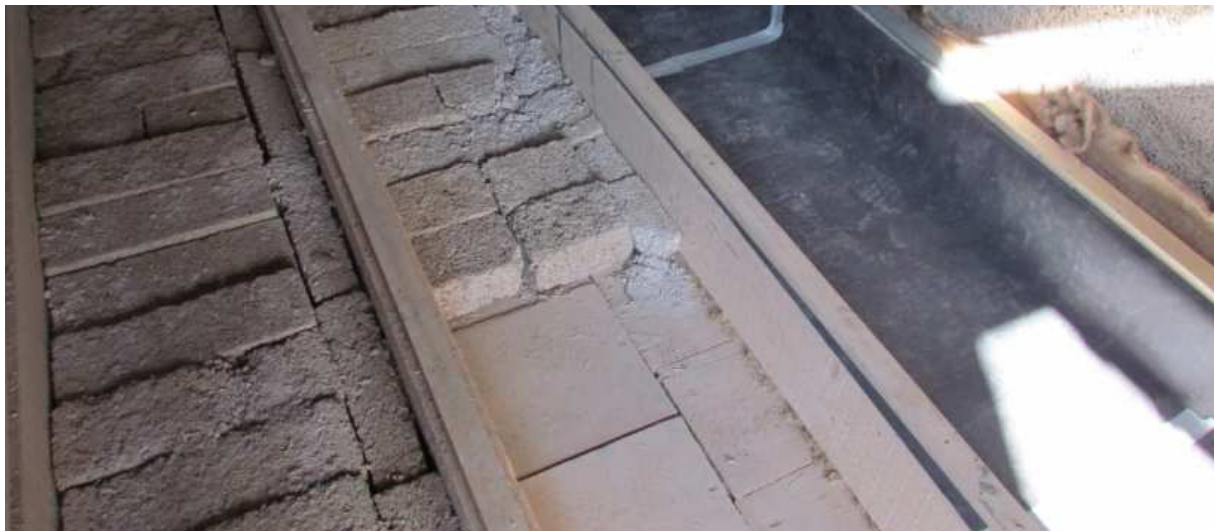
Fig. 3.205 Sperimentazioni di riempimenti di soali in blocchi, Cantiere di Cascina Corte Sacro Cuore, Casatenovo (LC), Arch. S. Sabbadini
