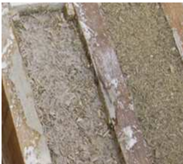
Fig. 3.74 Riempimento del solaio a strati alternati di canapulo e latte di calce, ANAB, (2011), Presentazione Cantiere Scuola: isolanti naturali, S.Matteo della Decima
