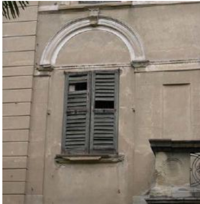
Figura 36 - Distacco della pietra arenaria costituente i davanzali delle finestre
