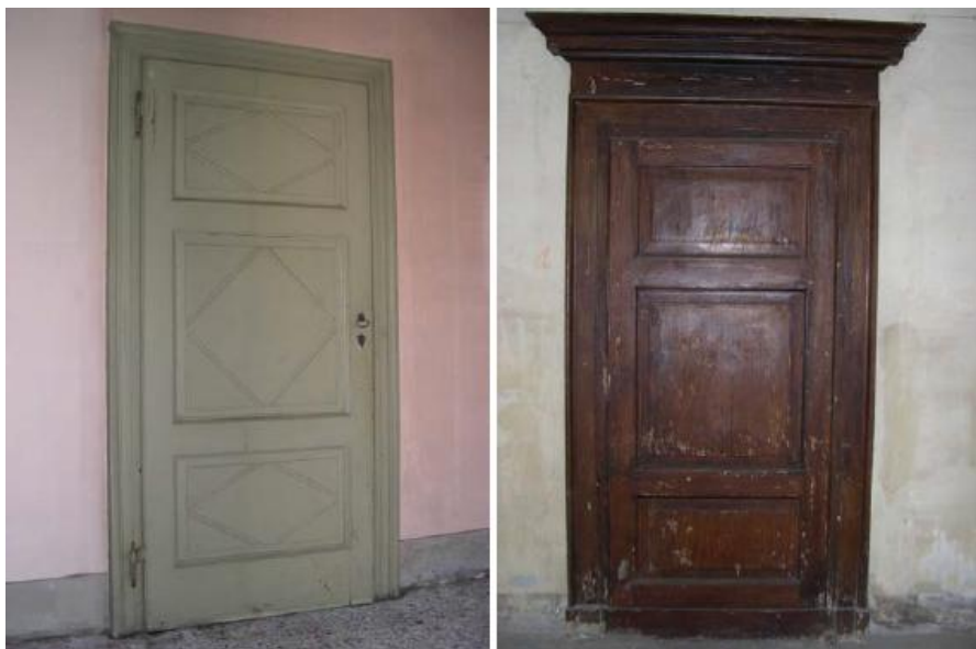
Figura 45 - Stato di conservazione dei serramenti interni
