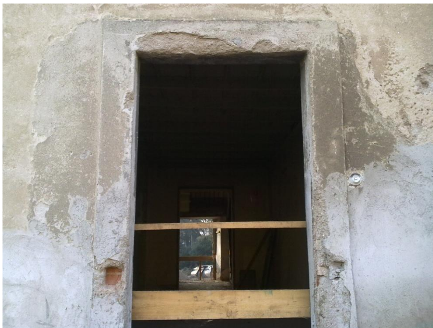
Figura 35 - Erosione e polverizzazione delle cornici delle aperture in facciata
