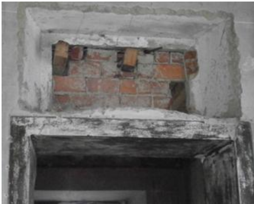
Figura 95 - Architrave da consolidare
