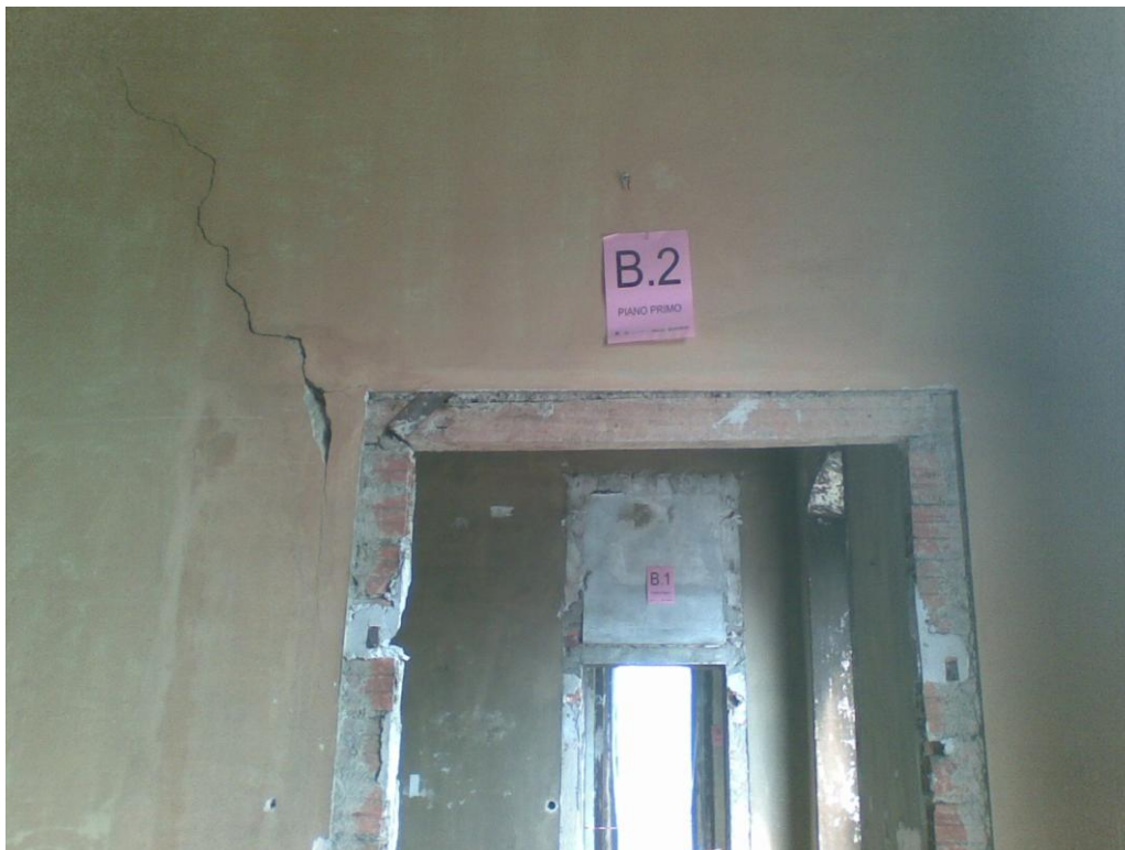
Figura 47 - Presenza di fessure nella muratura con andamento inclinato
