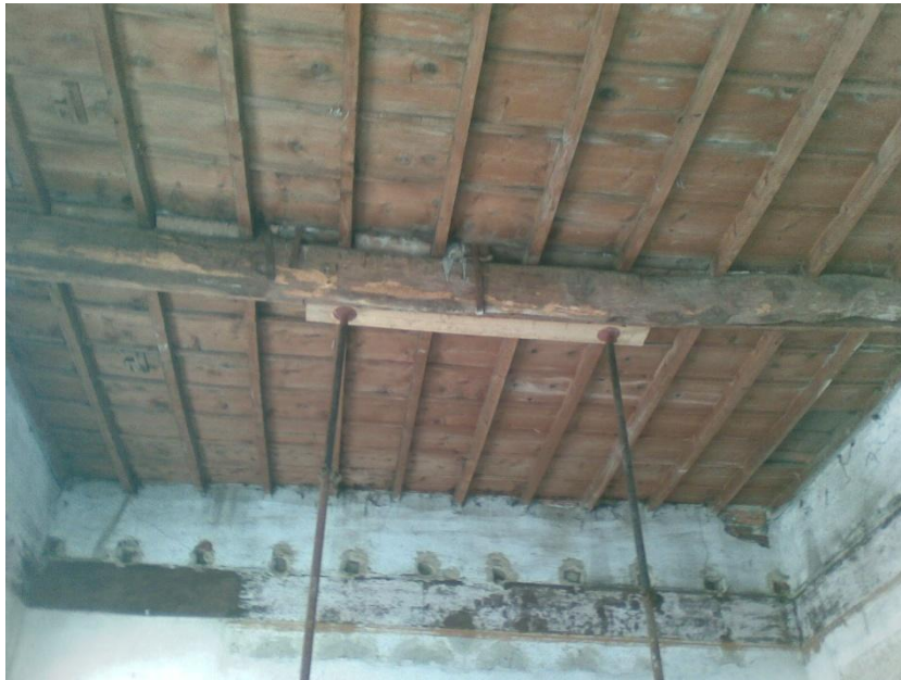
Figura 43 - Travi inflesse nel locale C al 1° piano
