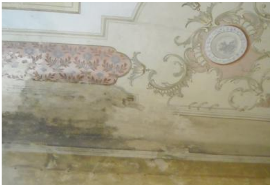
Figura 37 - Presenza di macchie da umidità
