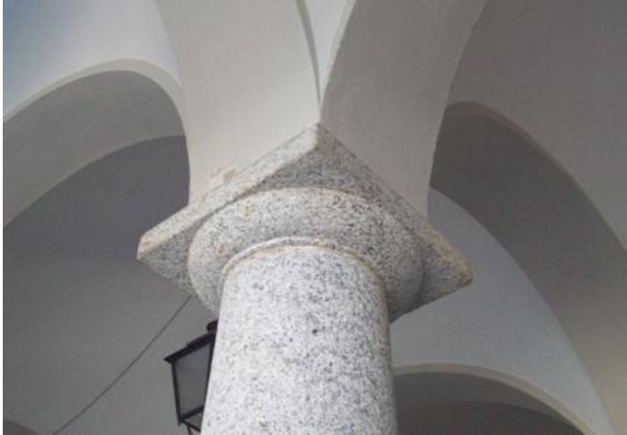
Figura 34 - Stato di conservazione delle colonne in granito bianco del portico
