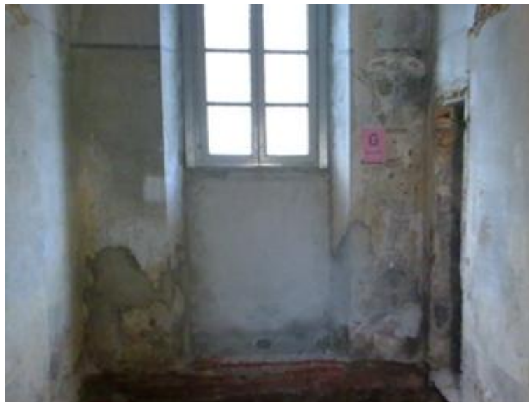
Figura 29 - Disgregazione dell'intonaco nel locale G al piano terra
