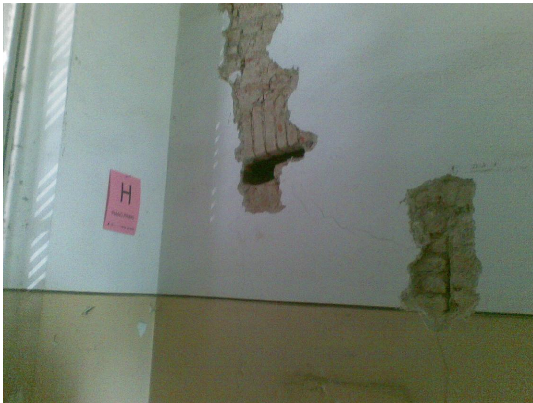
Figura 87 - Presenza di vuoti e discontinuità nelle murature
