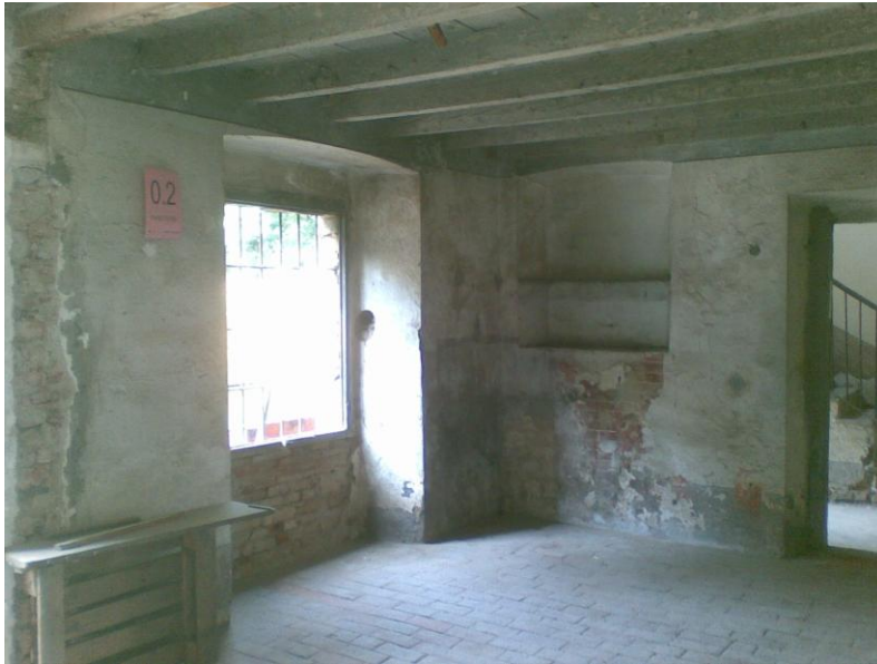
Figura 30 - Distacco dell'intonaco, locale 02 al piano terra
