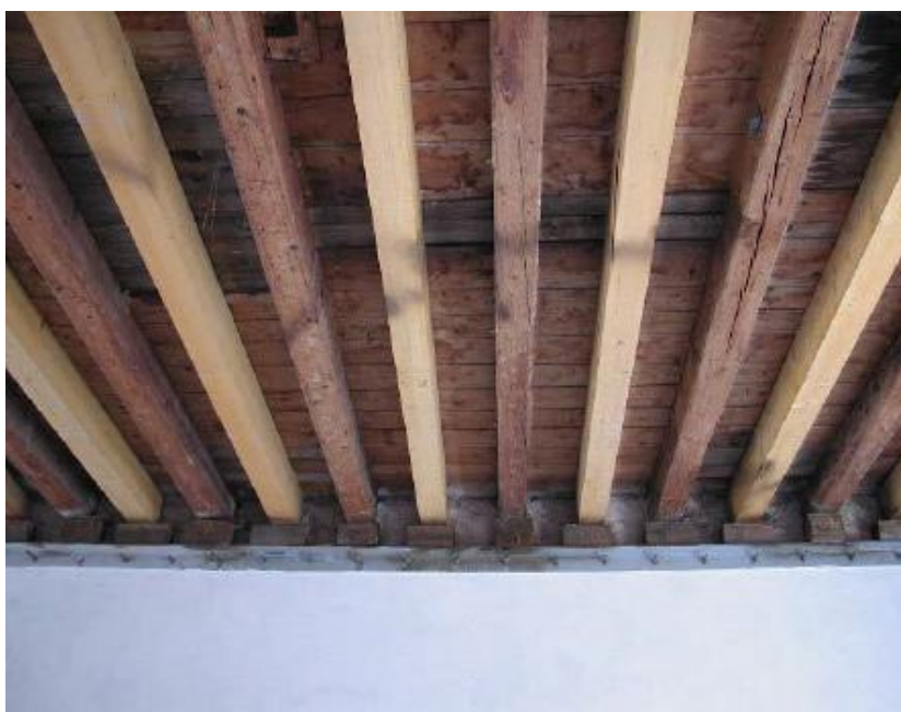
Figura 136 - Esempio di rinforzo mediante inserimento di travetti lignei, effettuato su un solaio di Casa ex Masciadri ad Arcene (BG)
