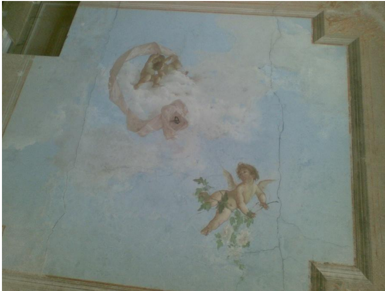
Figura 38 - Presenza di fessurazioni nel soffitto decorato
