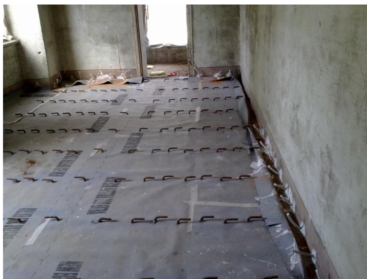
Figura 117 - Posa in opera della membrana impermeabilizzante e dei connettori di collegamento alla struttura lignea
