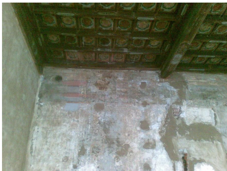
Figura 31 - Presenza di efflorescenze sulle pareti degli ambienti al 1° piano
