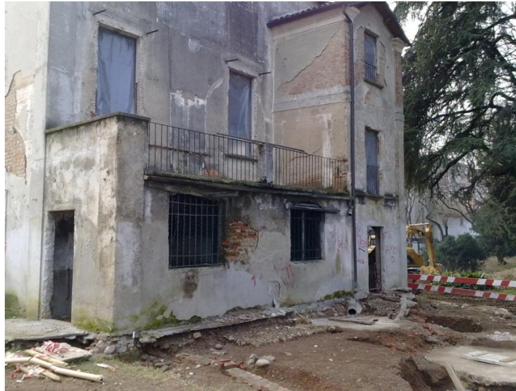
Figura 32 - Stato di conservazione degli intonaci esterni, fronte Nord
