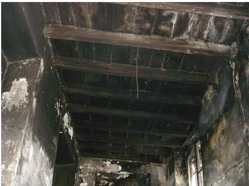
Figura 44 - Solaio del locale T al piano terra danneggiato da un incendio
