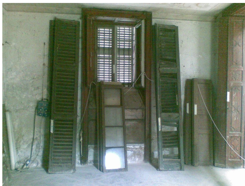
Figura 46 - Stato di conservazione dei serramenti esterni
