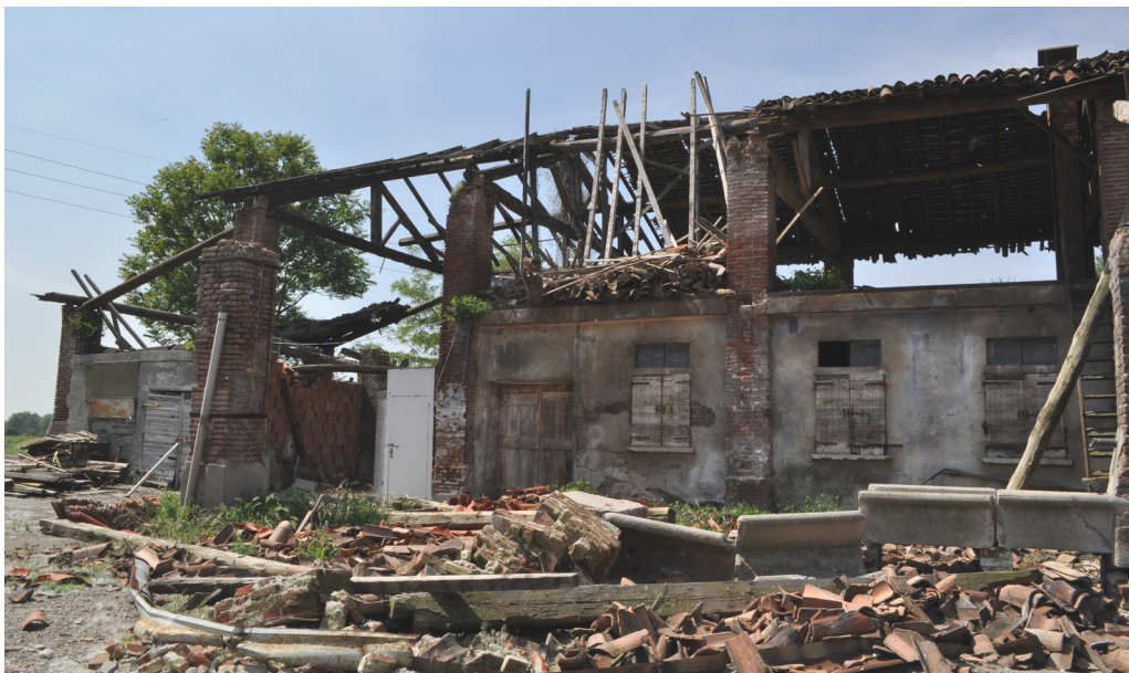
Corpo 3: edificio degradato
