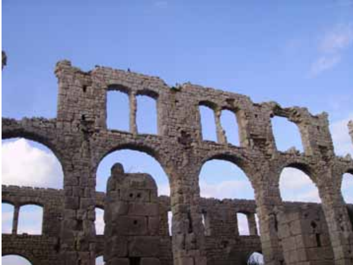
30. Attuale stato di degrado delle arcate interne
