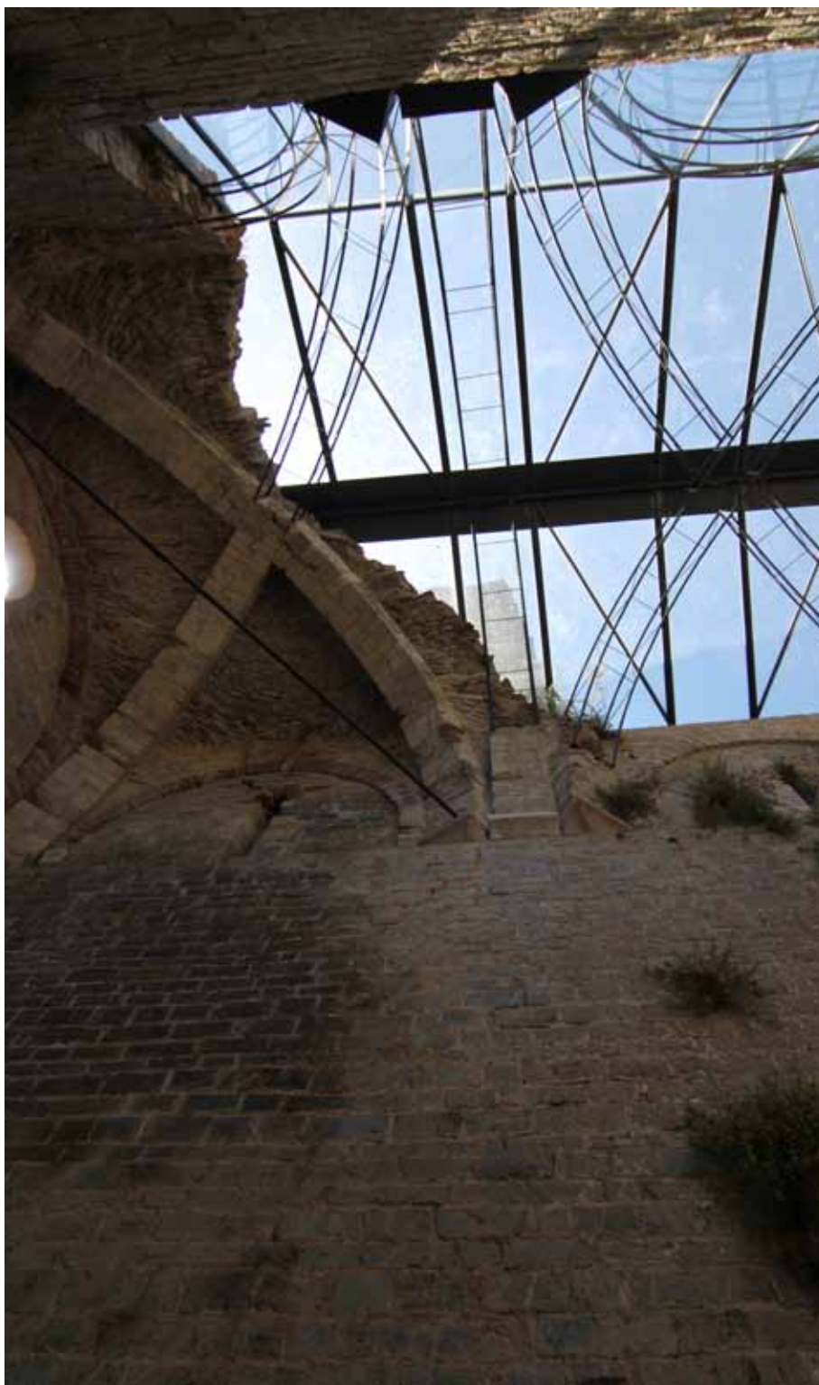
f 28 Particolare dell'interno della chiesa con la copertura in ferro zincato e lexan
