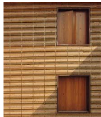
Figura 35. Rivestimento in listelli di legno. Fonte: http://www.portedilo.it
