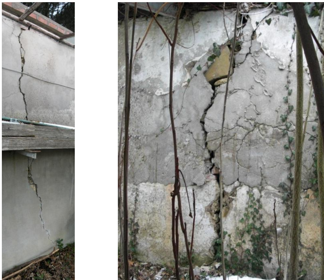
Foto 18: La fessura più significativa della Serra
