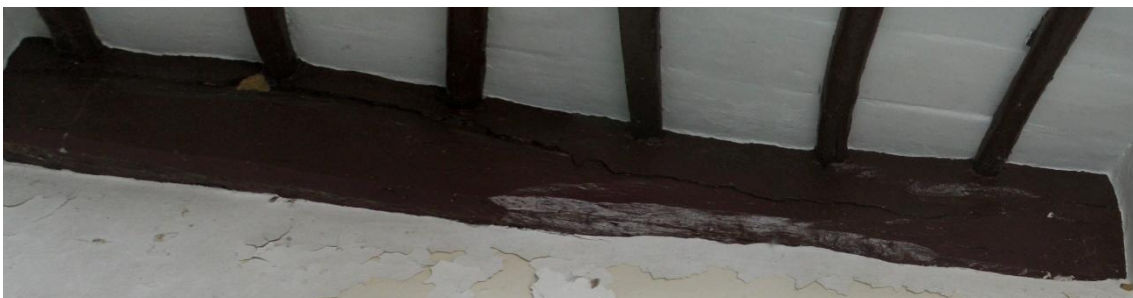
Foto 19: Particolari di ammaloramenti delle travi lignee
