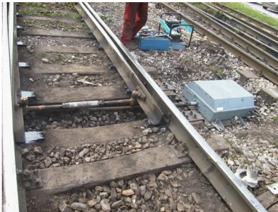
Figura 79: posizionamento cassetta controllo deviatoio
