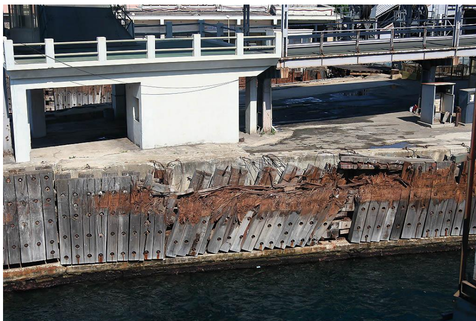
Figura 56: danno provocato dalle navi traghetto dovuto al mare agitato
