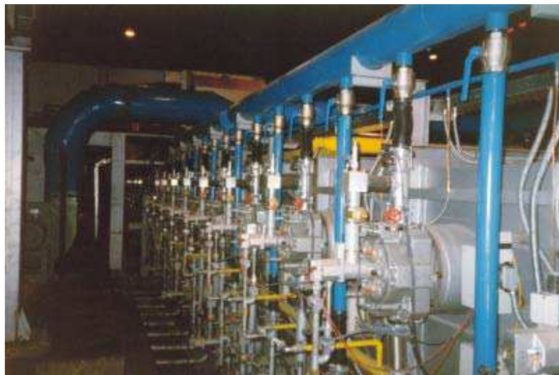
Figura 1.13: linea continua per la ricottura degli acciai inossidabili (AST-Terni). I bruciatori rigenerativi da 200 kW, tipo REGEMAT®, sono installati sulle pareti laterali del forno e forniscono una potenza totale di 12 MW termici [9].
