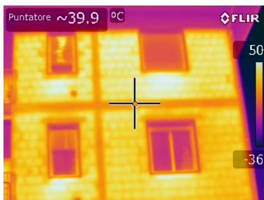
Figura 3.11 Lo spessore ridotto del muro sottofinestra aumenta le dispersioni termiche rispetto al resto della facciata. L'effetto è enfatizzato dalla presenza del radiatore che disperde buona parte del calore verso l'ambiente esterno
