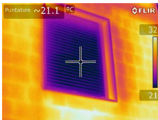
Figura 3.12 Presenza di infiltrazioni d'aria nella giunzione tra telaio mobile e telaio fisso e tra telaio fisso e muro perimetrale esterno
