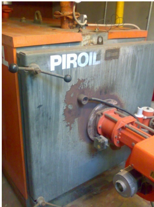
Figura 3.20 Caldaia in acciaio di tipo standard e bruciatore a metano del tipo bistadio
