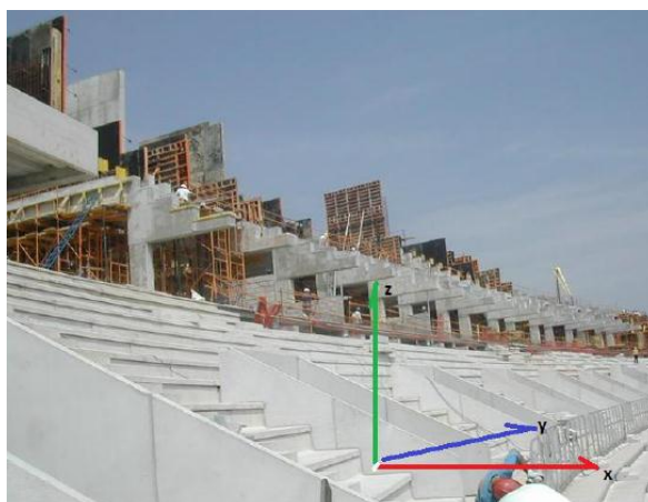
Figura 2.1: Fase di costruzione di uno stadio di calcio con indicato sistema di riferimento
