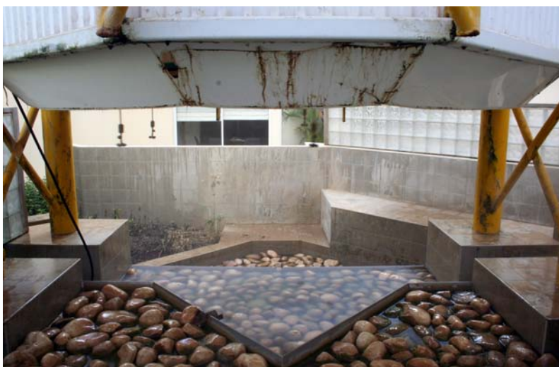
Bocca di uscita della torre di raffreddamento per evaporazione a caduta vasca di raccolta dell'acqua - fotografia dell'autrice
