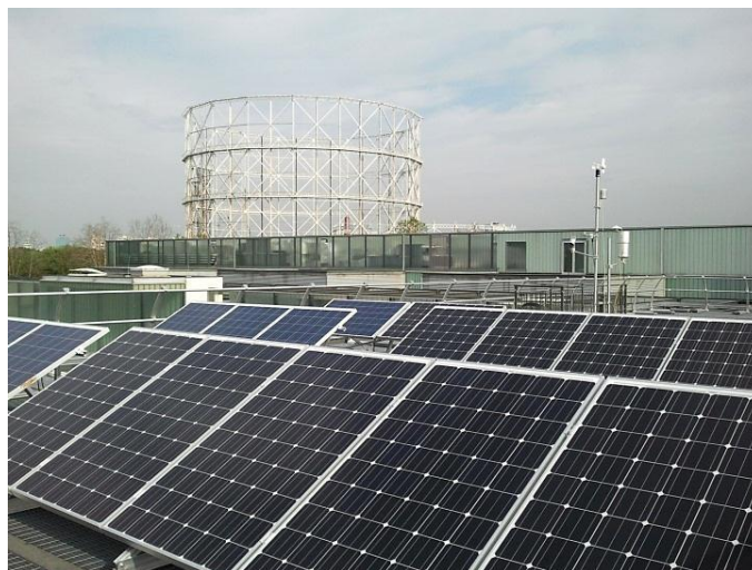
Figura 4.1-Moduli installati al SolarTech Lab
