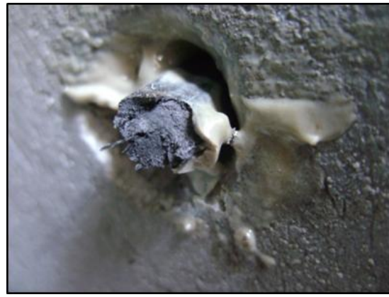
Figura 6.2 – Particolare rottura connettore campione C1
