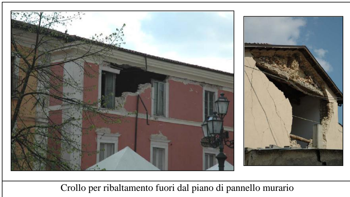
Figura 1.1 – Danni provocati dal sisma su pannelli murari
