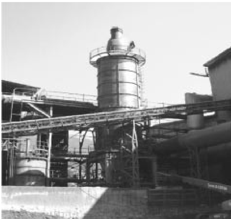
Figura 1.12 - Torre di raffreddamento
