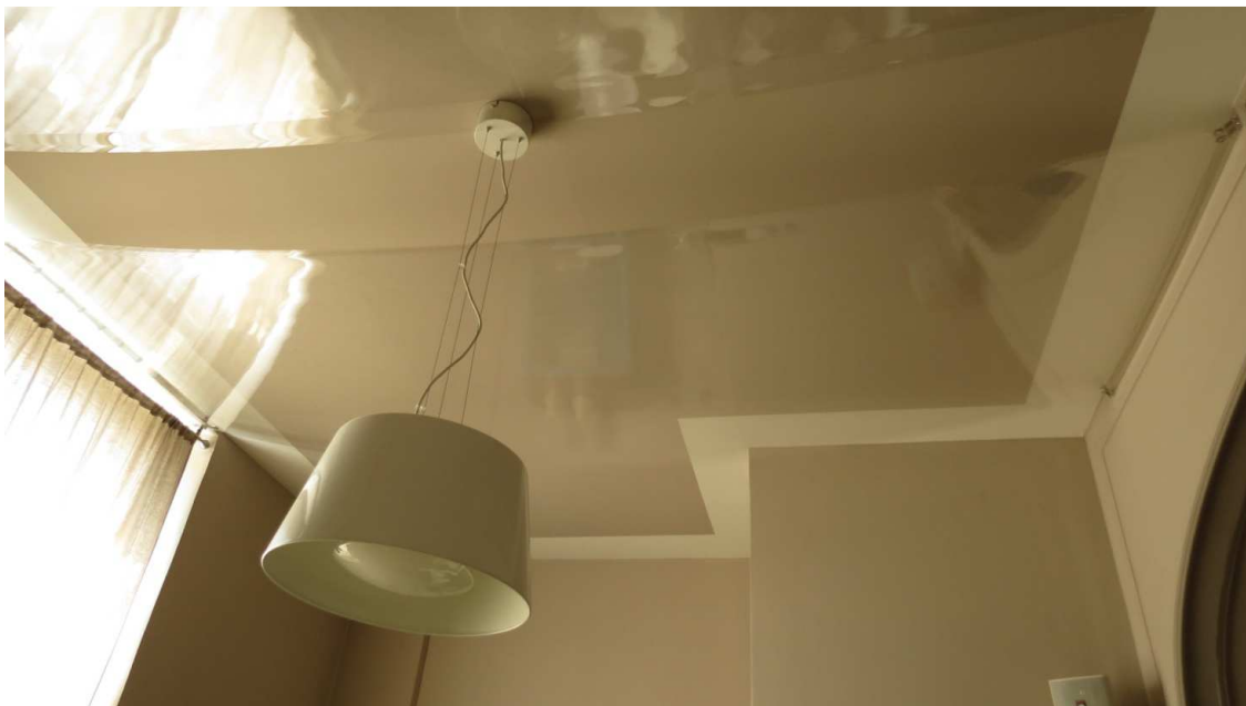
Figura 7.91. Sala di sinistra; anche qui, come in tutti i soffitti, è stata installato un doppio strato di pellicola Microsorber®
