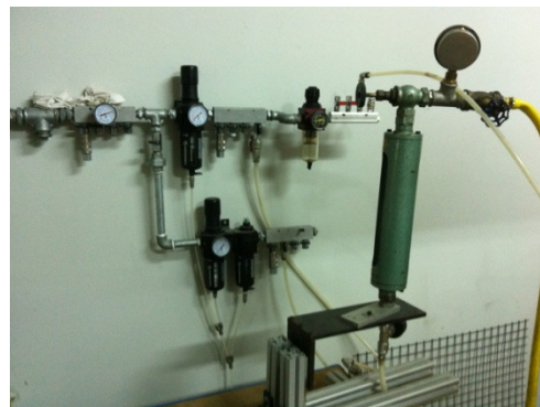
Figura 28 - Impianto pneumatico con flussimetro
