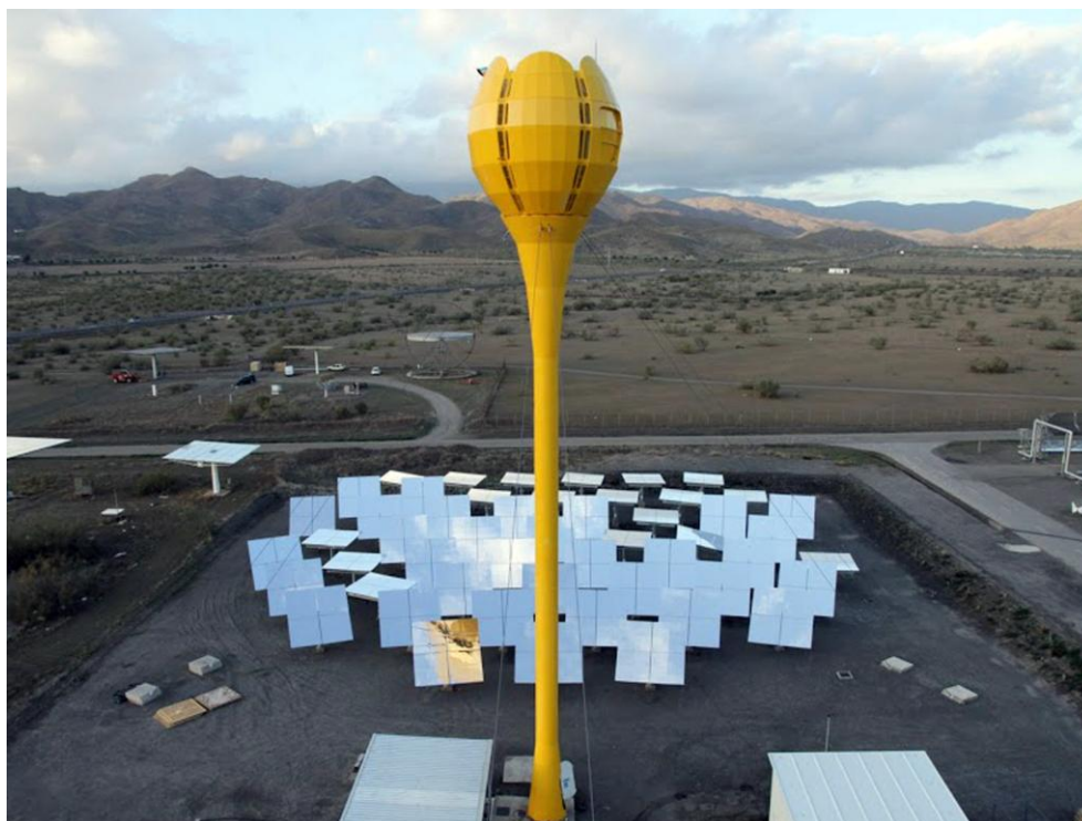
Figura 15: Fotografia della torre a fiore di AORA
