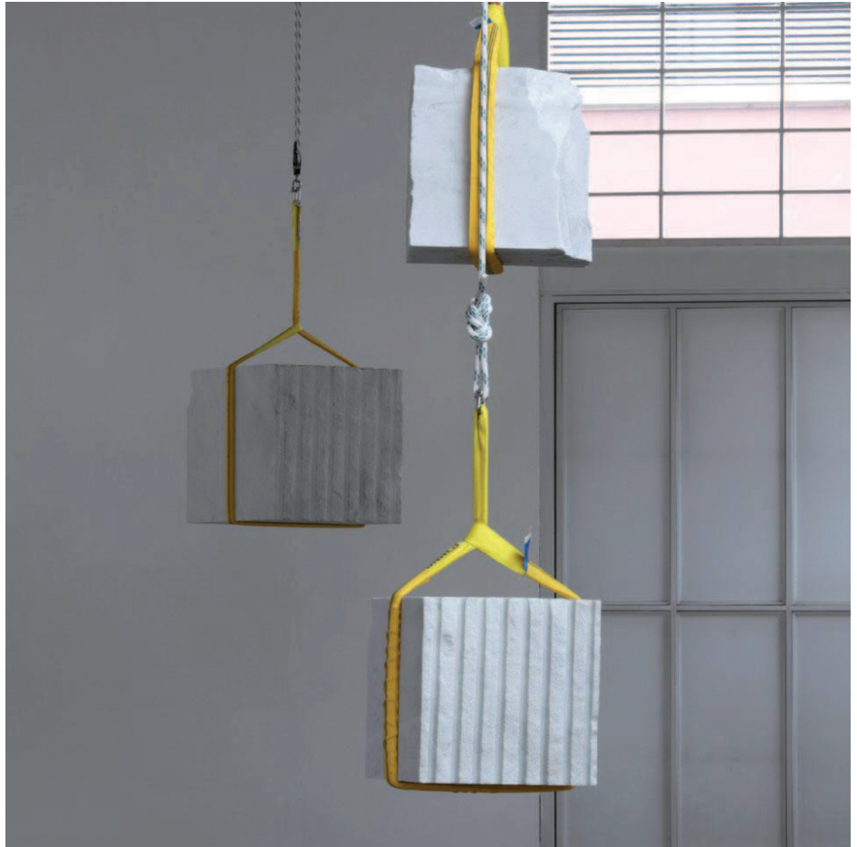
Inserimento blocchi di marmo nel chiostro per mezzo di gru. Blocchi sospesi sul chiostro non solo per la loro posa ma anche durante l'installazione
