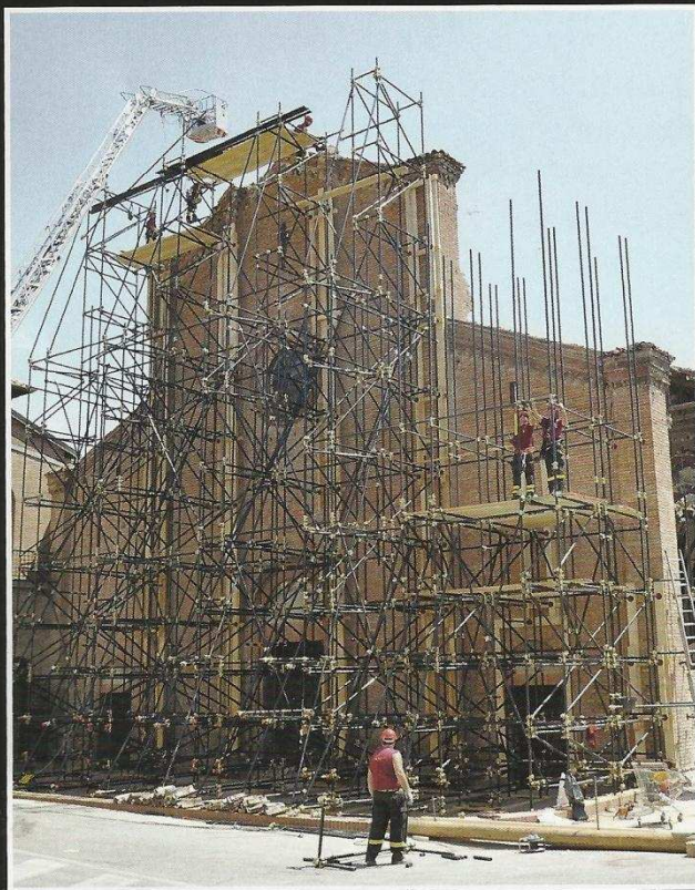
Chiesa di San Francesco a Mirandola dopo il terremoto
