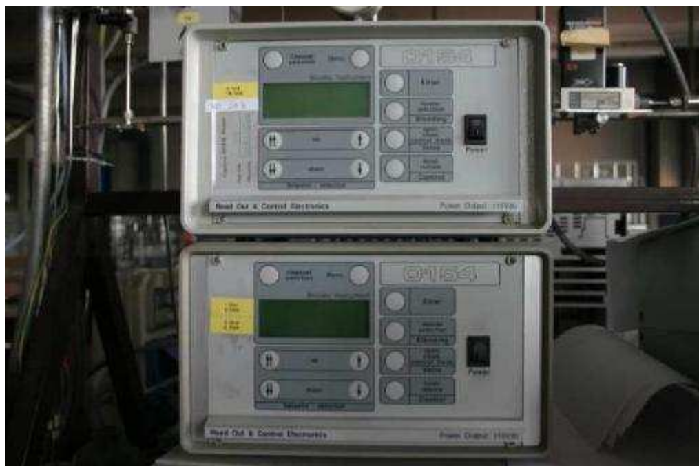
Figura 2.10 Centraline di controllo dei regolatori di flusso.
