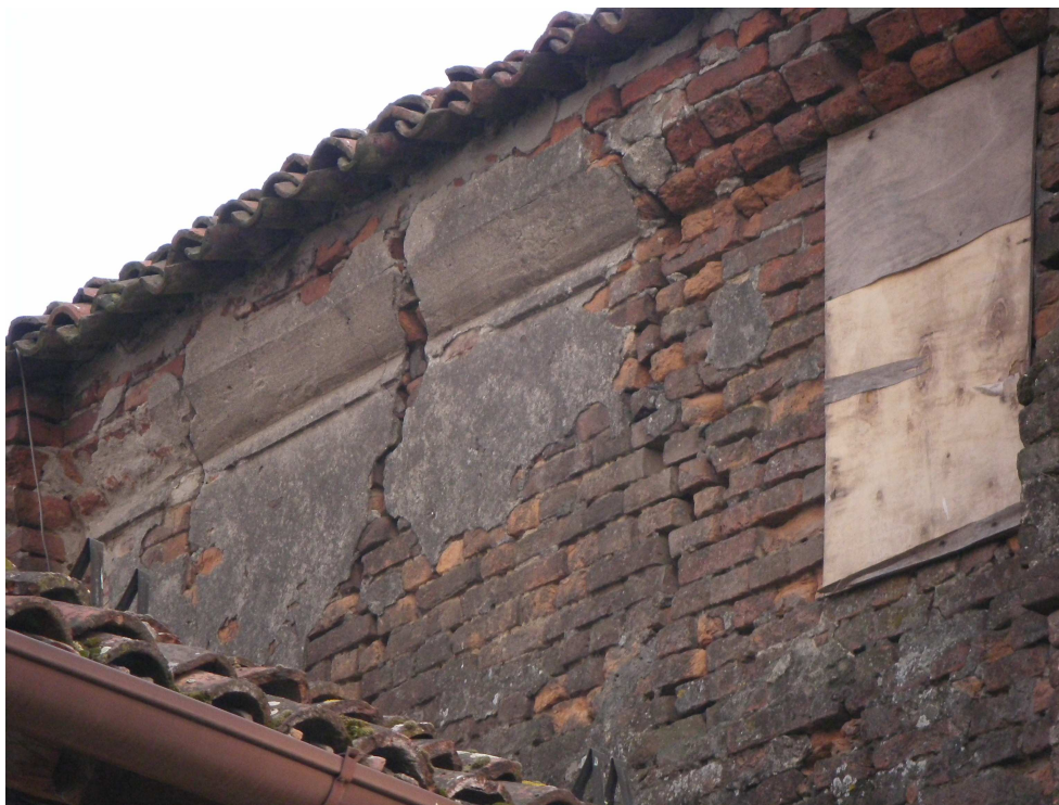
Figura 3-25 Fessurazioni passanti in corrispondenza all'altezza del sottotetto [24/03/2012].
