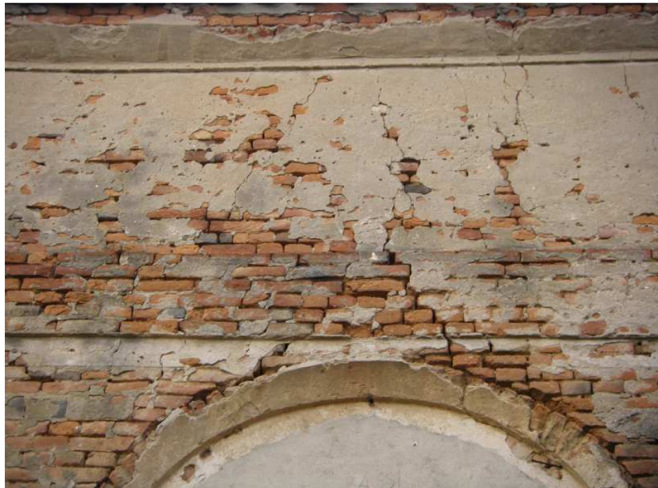
Figura 3-29 Fessurazione passante sul lato nord della cappella della chiesa [24/03/2012]
