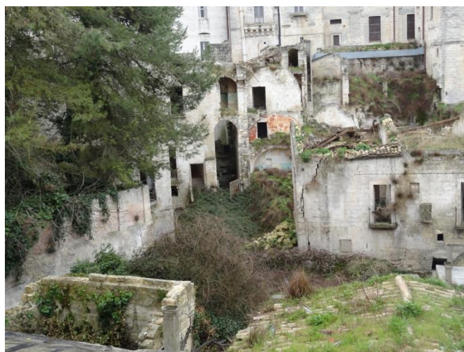
Figura 3-63 Immagine di edifici diroccati nel Rione Piaggio
