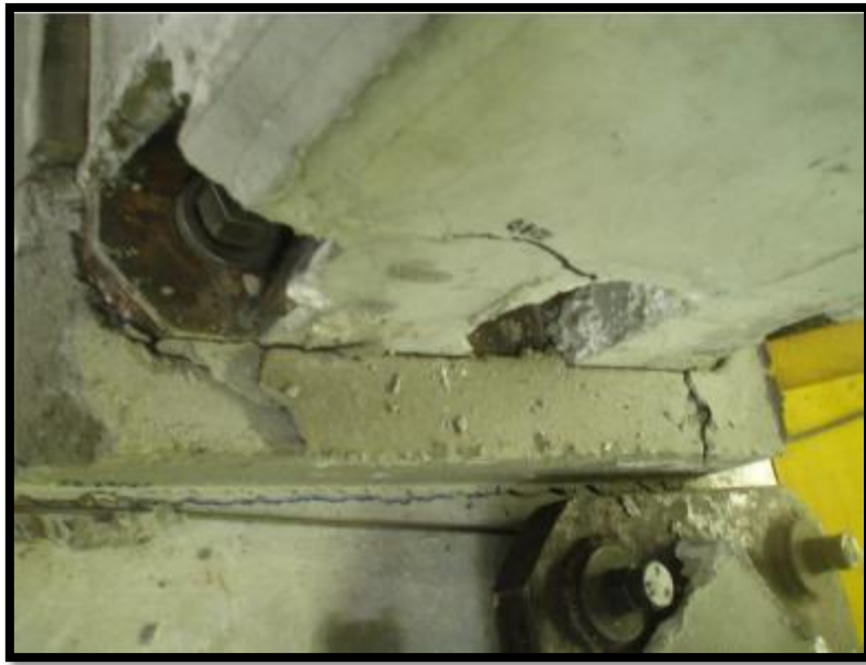
Figura 2.31 Fessure alla base del pilastro e nella malta
