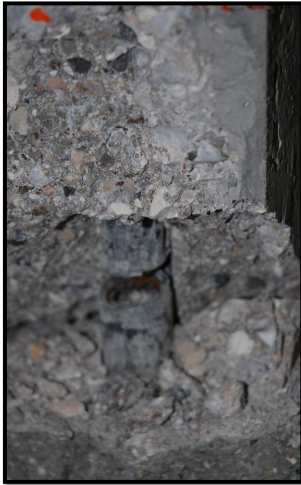
Figura 2.42 Particolare di una barra rotta al 4,5% di drift
