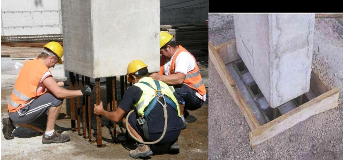
Figura 1.22 Inserimento della pilastro prefabbricata all'interno dello scatolare e preparazione del cassero per getto di completamento[www.ape.it]
