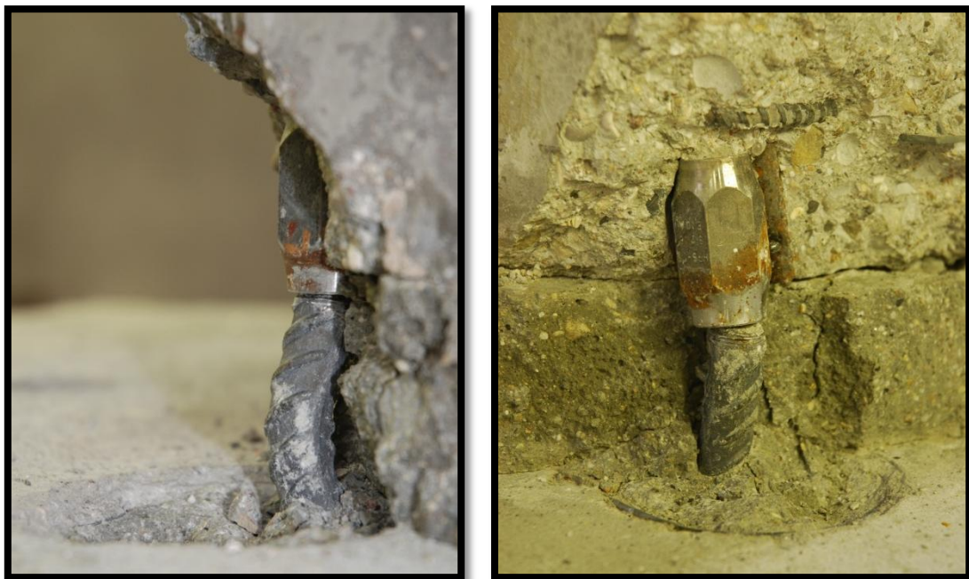
Figura 2.57 Rottura duttile delle barre in corrispondenza della barra filettata
