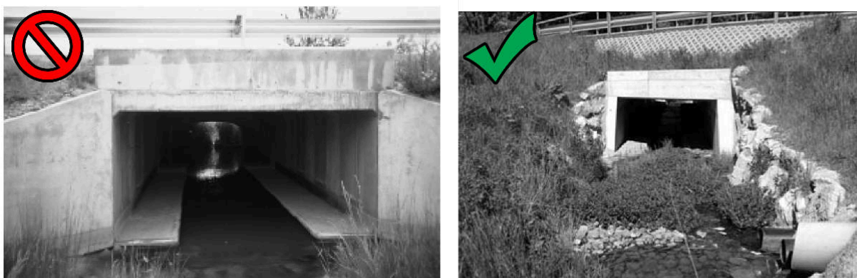
Fotografia 48: Sulla sinistra un manufatto scatolare con passerelle non collegate al territorio; sulla destra la soluzione corretta con collegamento e vegetazione di invito (Fonte: AA.VV., 2006. Fauna selvatica..., op cit.)
